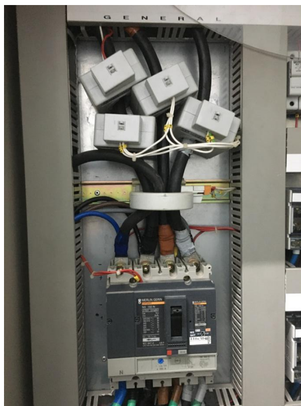
Figura 2.2 Interruptor General de Alimentación
