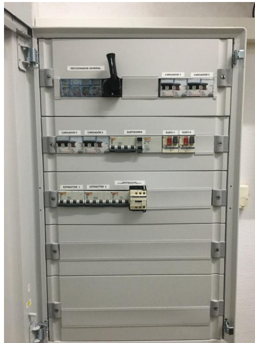
Figura 2.6 Protecciones derivaciones individuales (recarga coches eléctricos)
