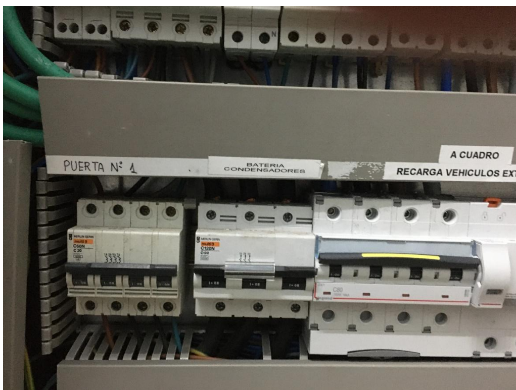
Figura 2.5 Protecciones derivaciones individuales (3)
