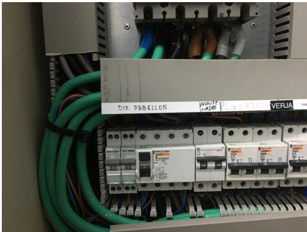
Figura 2.4 Protecciones derivaciones individuales (2)
