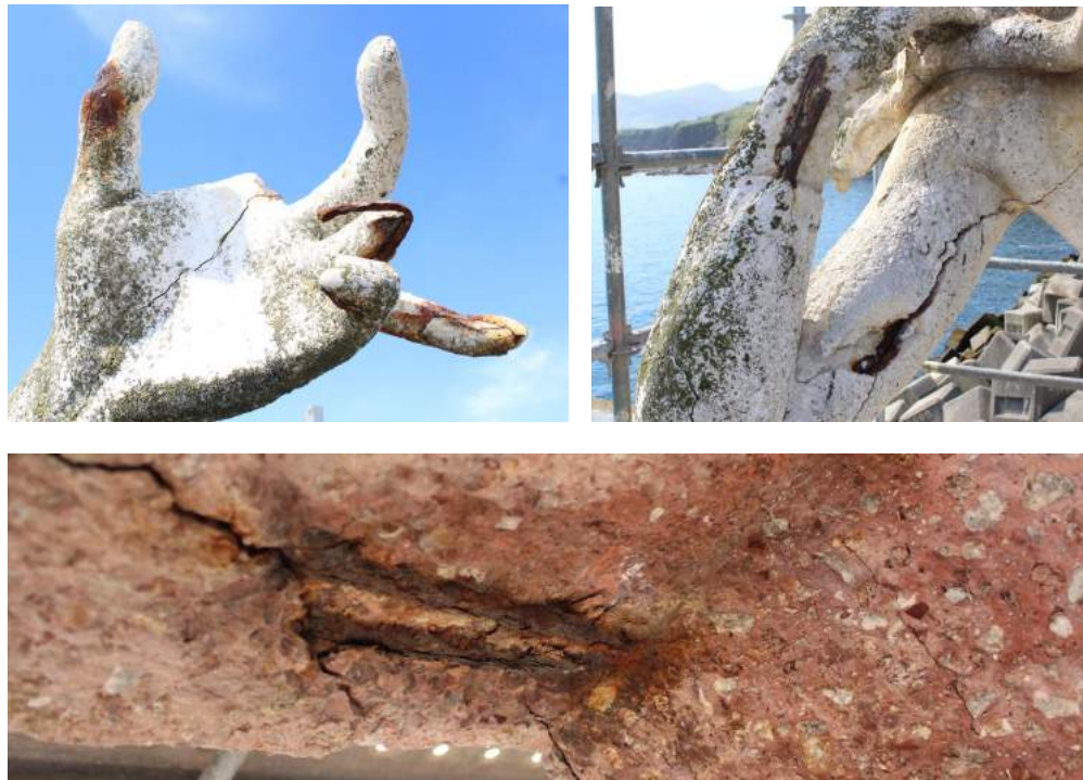
Figura 40, 41 eta 42. Ezkerretik eskuinera: 40) Narriadurak lamiaren eskuan armaduraren korrosioaren ondorioz. 41) Narriadurak lamiaren besoan armaduraren korrosioaren ondorioz. 42) Narriadurak arrantzaleen sudurraren azpiko aldean armaduraren korrosioaren ondorioz.
