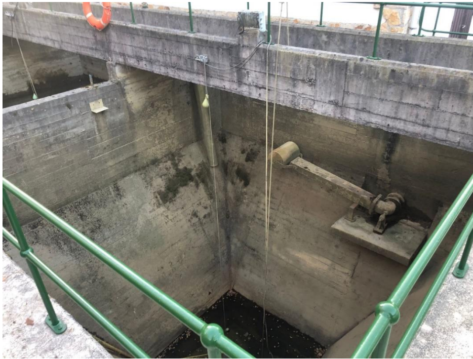
Figura 14. Válvula flotadora del Pozo 2.
