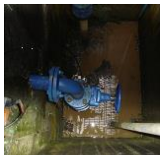
Figura 18. Válvula de purga de concentradores.
