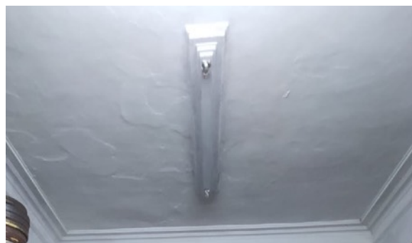
Figura 37. Iluminación con tubos fluorescentes.
