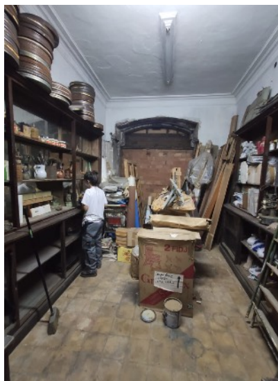
Figura 32. Pared del almacén tapiada de ladrillo que da a la calle. Fotografía realizada en 2020.
