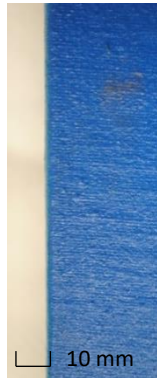
Figura 91. Acumulación de suciedad superficial.
