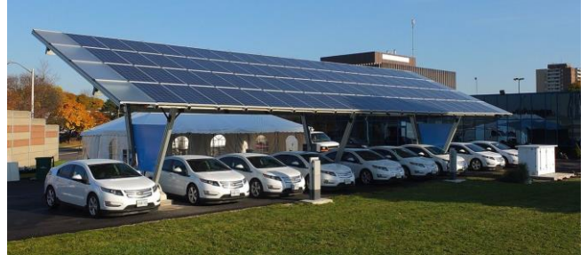
1. irudia. Energia fotovoltaikoa erabiltzen duten ibilgailu elektrikoaren karga-estazio jasagarria.
