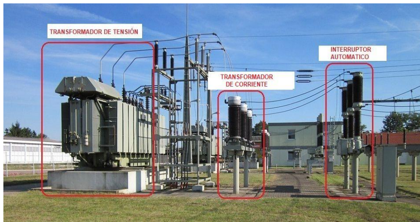
Figura 4. Transformadores de medida [5].
