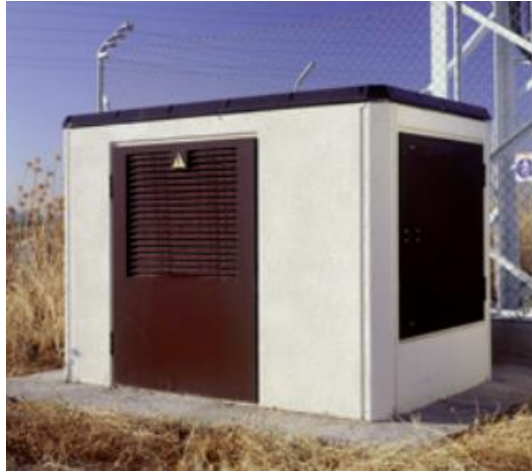
Figura 7- 18. Ejemplo de centro de transformación.
