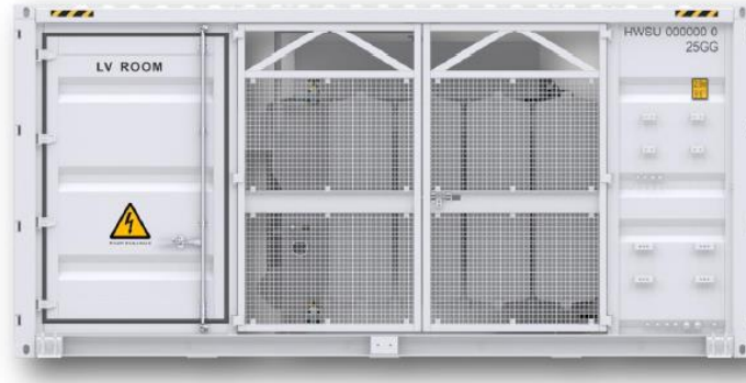
Figura 7. Centro de transformación de Huawei.
