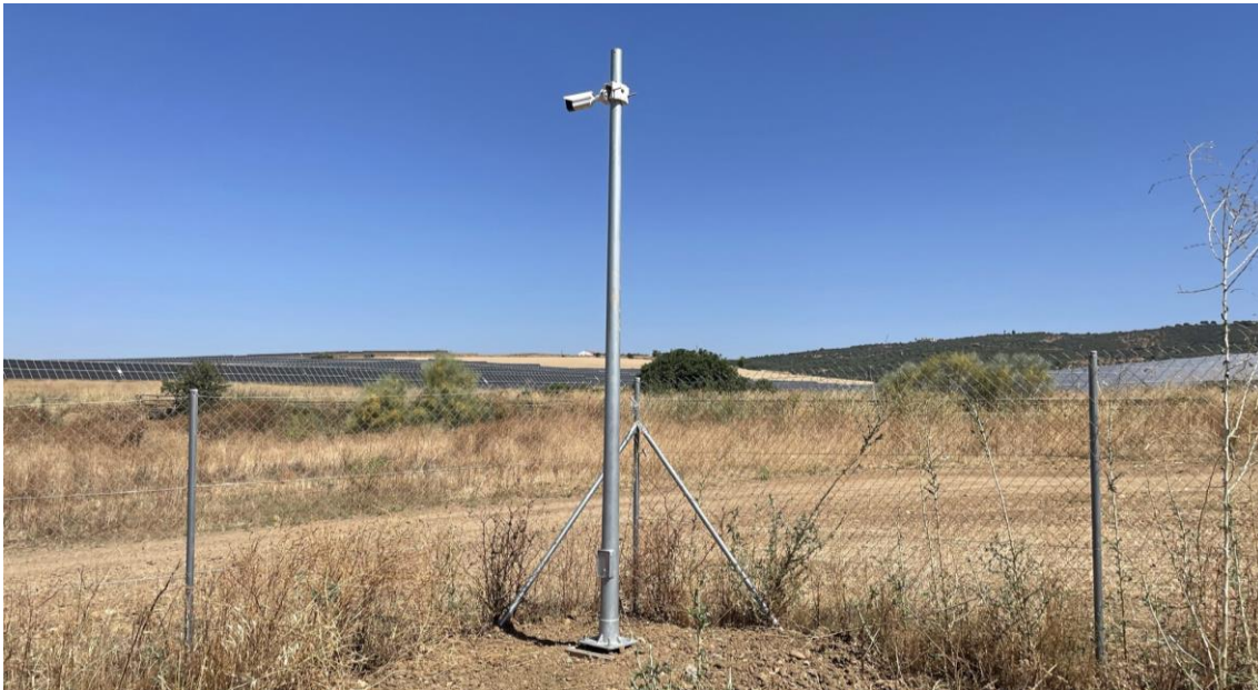
Figura 31. Ejemplo de cámara de seguridad en un vértice del cerco perimetral.
