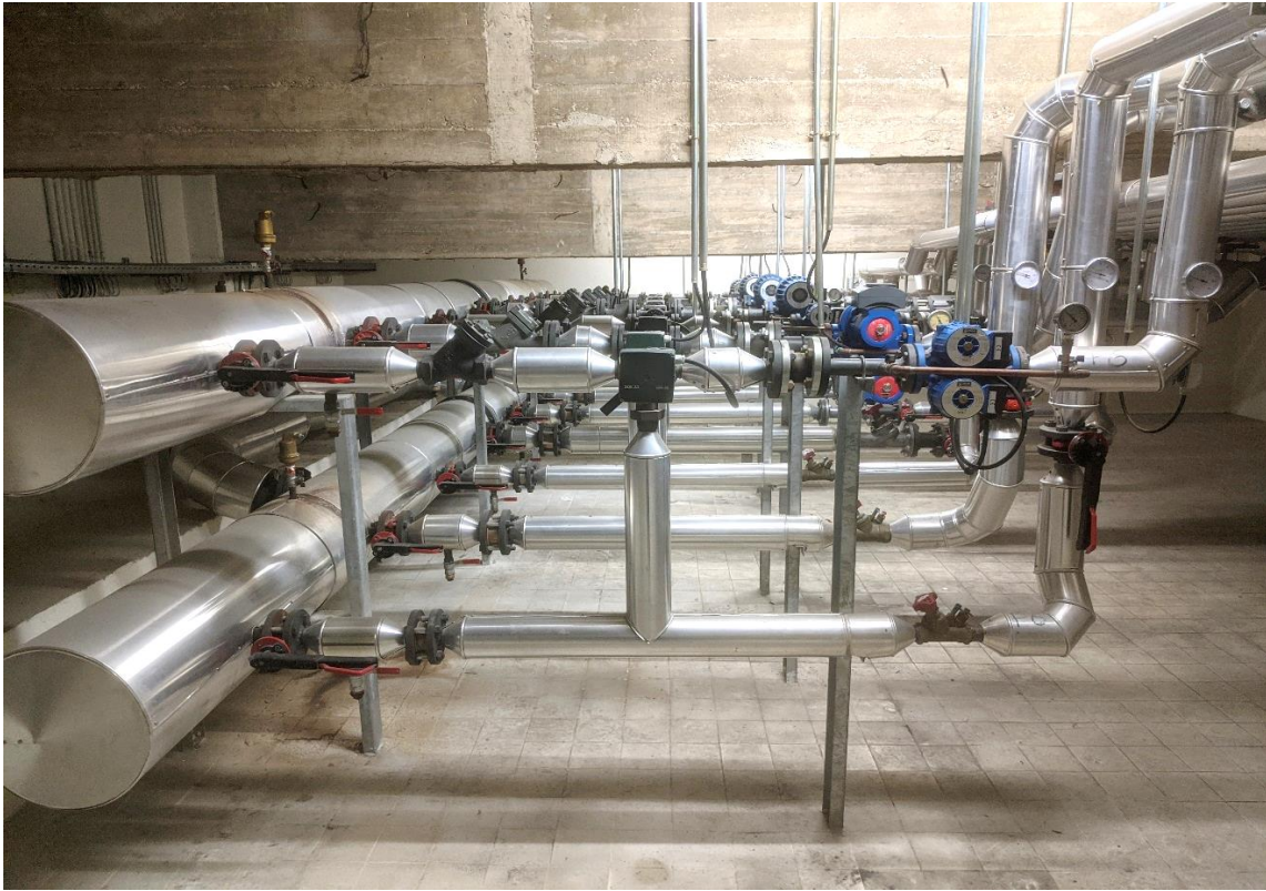
Figura 7 Sala de distribución. De izquierda a derecha: Colectores, llaves manuales, filtro, válvula motorizada y bombas.
