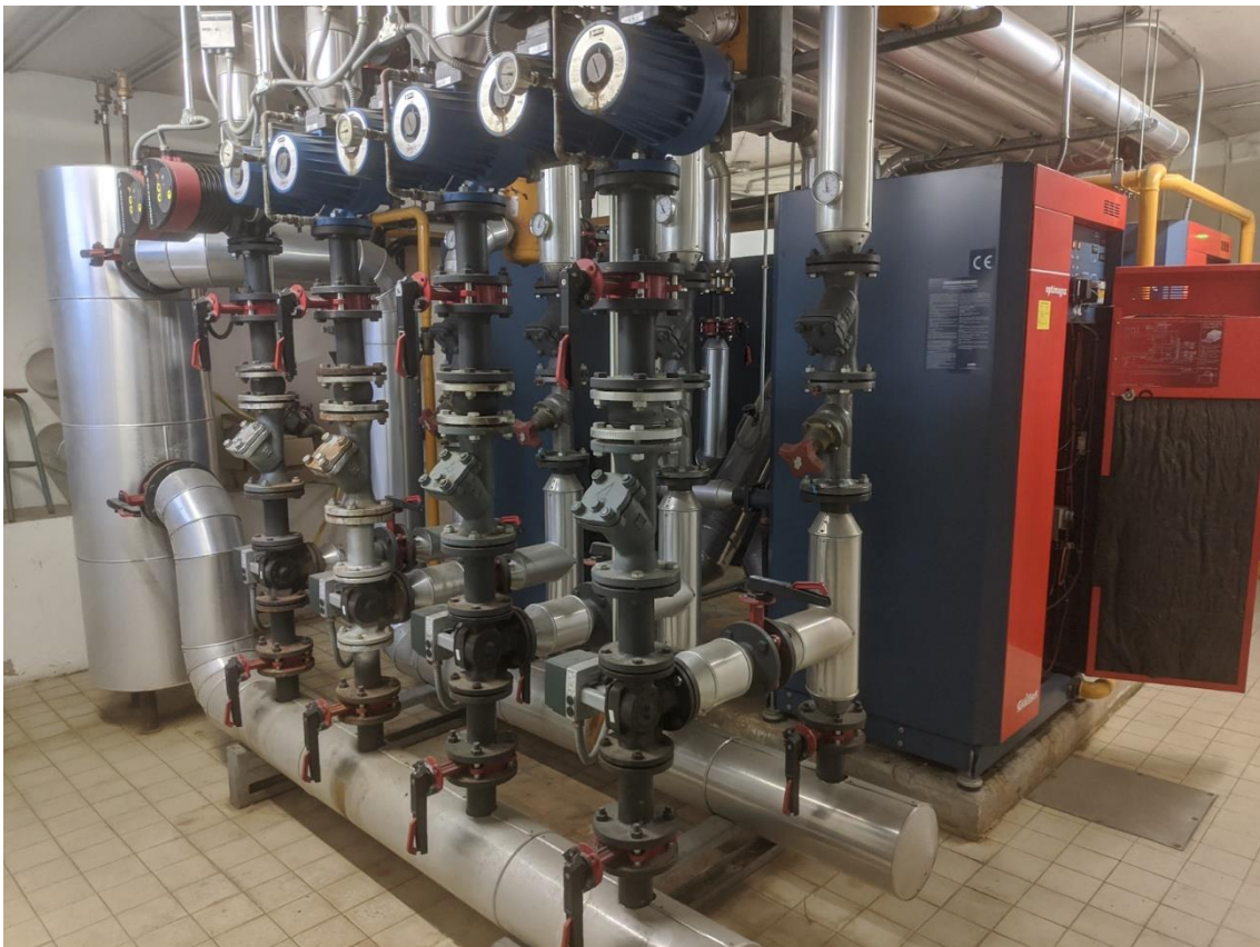
Figura 4 Circuito de calderas y Calderas
