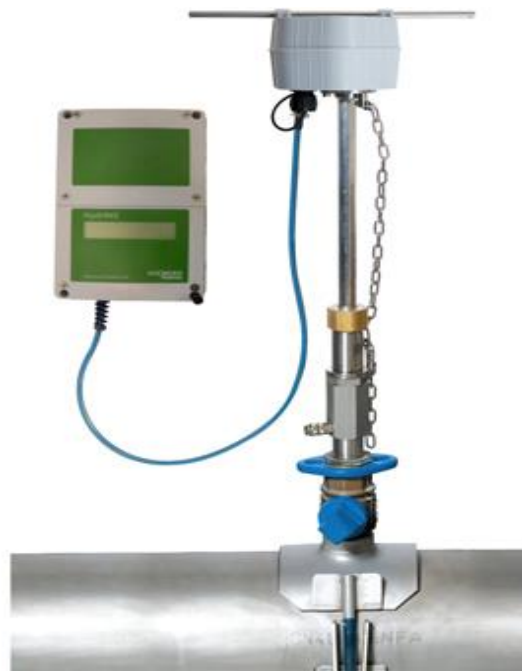
Figura 33 Caudalímetro electromagnético colocado sobre una tubería metálica
