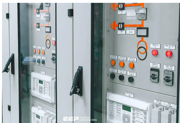
Figura 2.1: IEDs alojados en un armario rack dedicado al sistema de protección.
