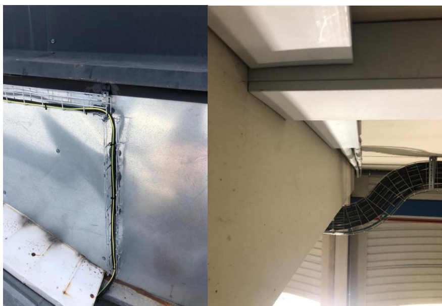
Imagen 64. Canalización y la entrada de los cables en la nave
