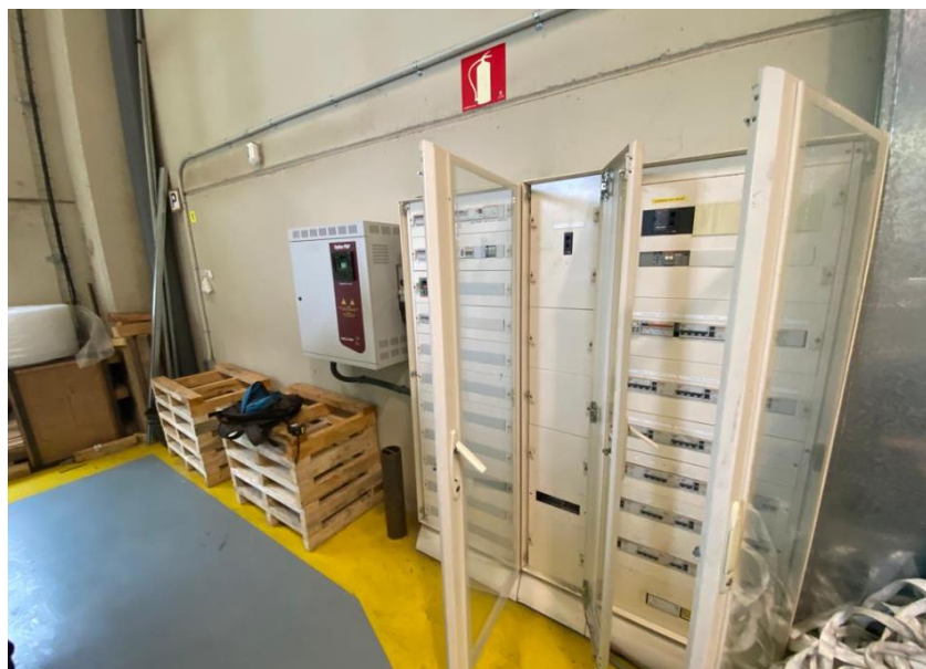
Imagen 32. Cuadro eléctrico de la empresa
