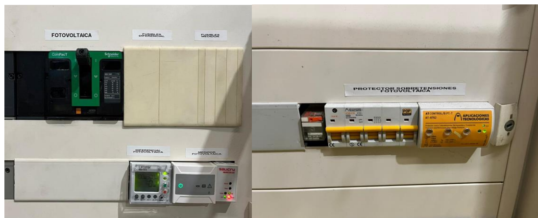
Imagen 67. El cuadro eléctrico
