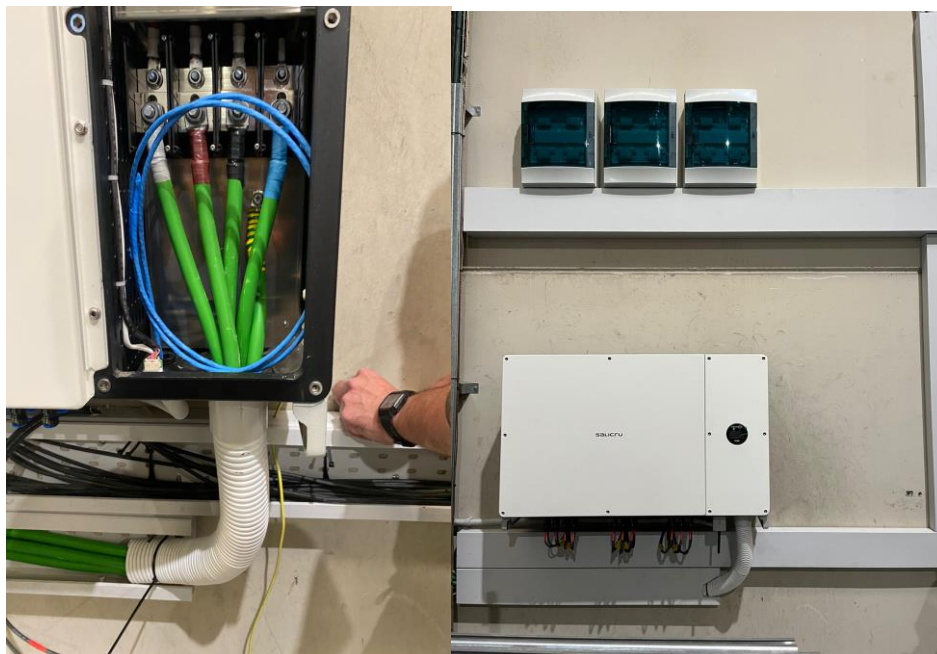
Imagen 66. Instalación en el interior de la nave
