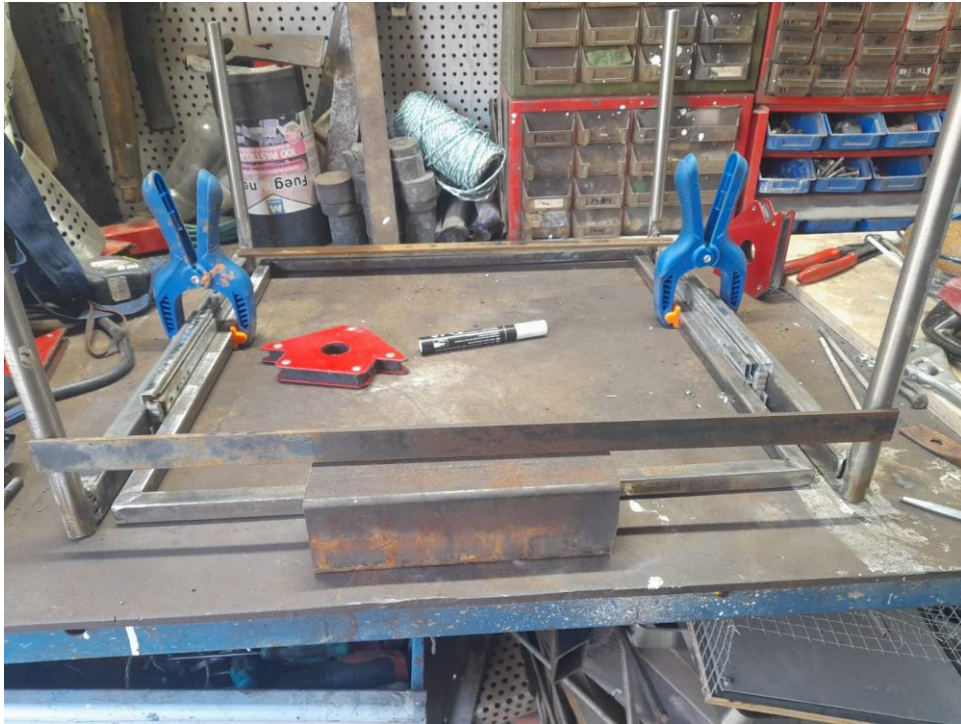
Ilustración 4 Estructura del medio despues de ser soldada y preparada para enlazar con la estructura superior
