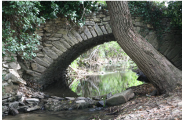
Figura 249. Puente de Iturzabaleta (siglo XVIII). Nivel de Protección Media, Gobierno Vasco. Fuente: elaboración propia
