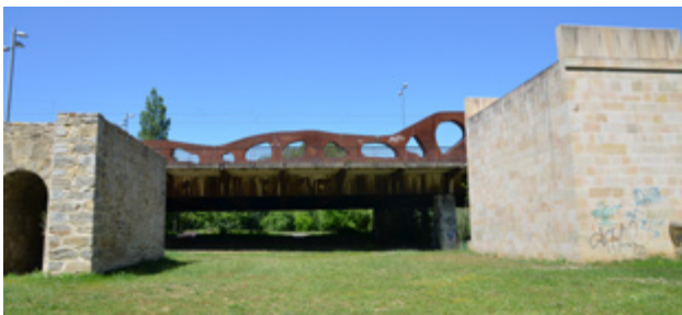
Figura 256. Hueco abierto en el puente viejo que coincide con el del puente nuevo, lo que amplía la capacidad hidráulica del conjunto. Fuente: elaboración propia
