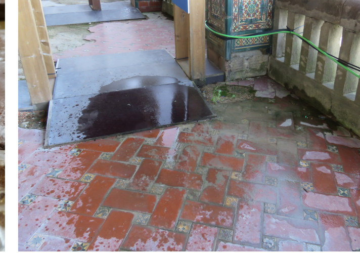
8. FILTRACIONES DE AGUA PLUVIAL (Figura 38).
