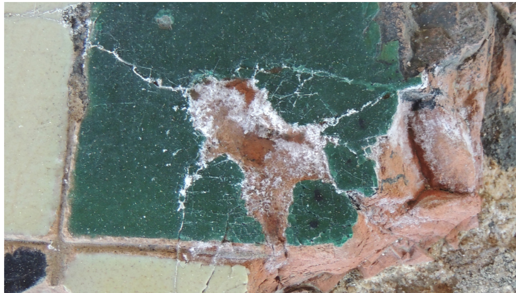
Figura 55. Afloramiento de sales en el interior de azulejos.
