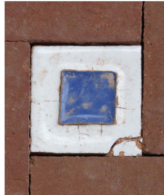
Figura 75. Rotura de pieza por falta de mortero y mala nivelación.
