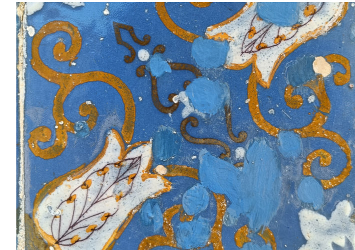
13. RESTAURACIÓN DEFICIENTE (Figura 43).
