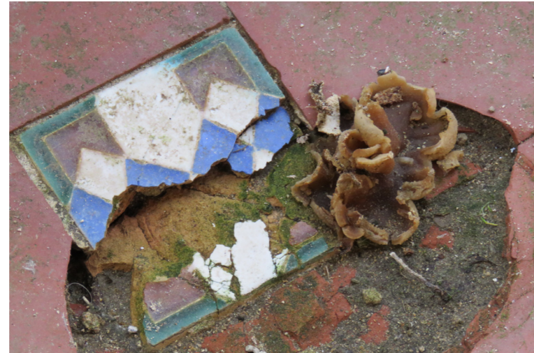
Figura 65 (dcha.). Lique presente en pavimento cerámico fracturado.
