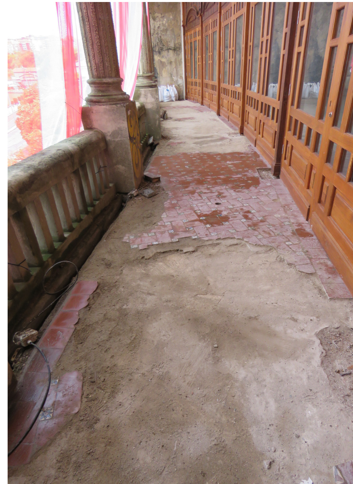
Figura 1. Estado de conservación del pavimento cerámico en la terraza del salón de las Galerías Punta Begoña, 2019 (Getxo).
