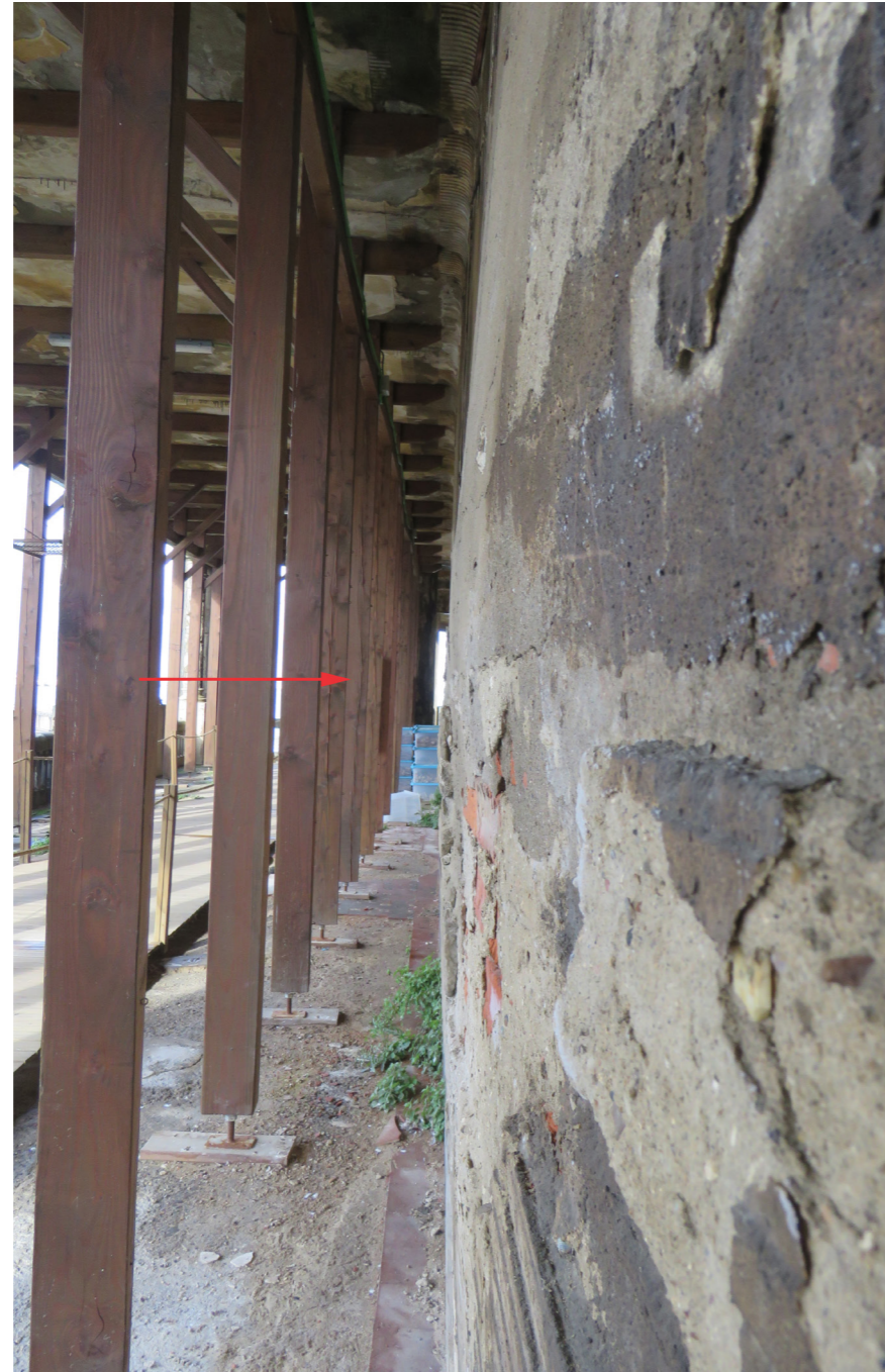
Figura 69. Deformación a modo de abombado del muro (vista de perfil).
