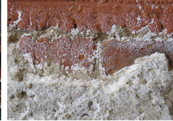
6. SALES EN MURO Y MORTERO (Figura 36).
