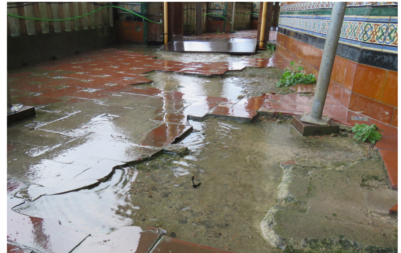
Figura 64. Acumulación de aguas pluviales debido a la ubicación exterior y orientación costera del bien. Galerías Punta Begoña (Getxo).
