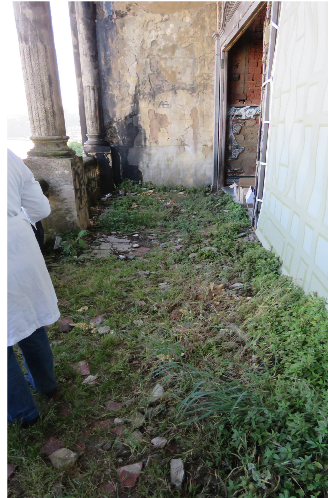
Figura 29. Vegetación y escombros cubriendo suelo cerámico (salón Galerías Punta Begoña).
