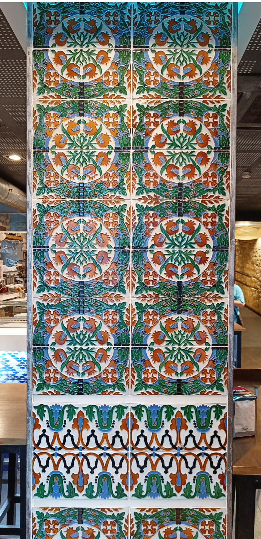
Figura 27 (izq.). Disposición incorrecta de las partes de un zócalo que revisten la columna tras unas labores de restauración en 1999 (Restaurante La Viña de San Francisco, Bilbao).
