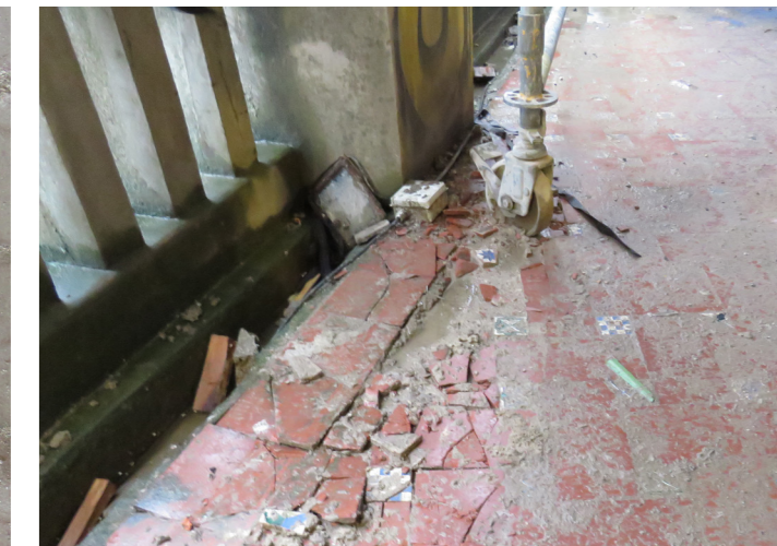
24. DETERIORO POR OBRAS (Figura 54).
