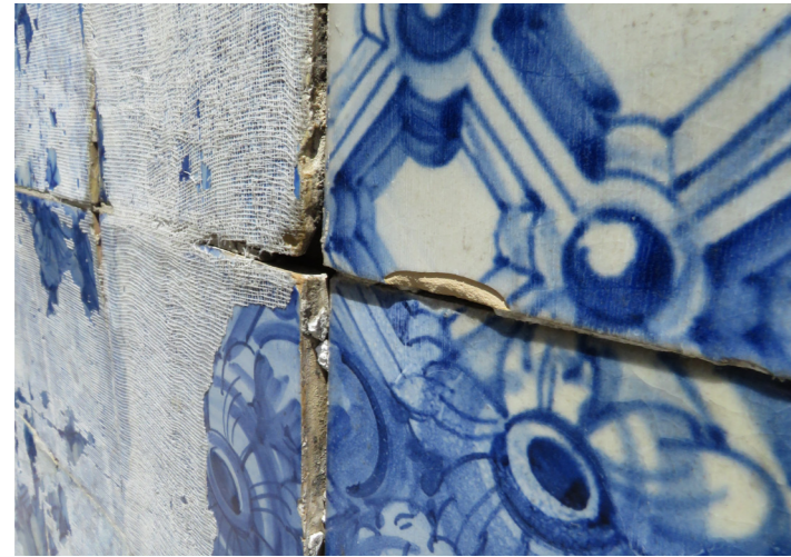
10. DEFORMACIÓN DEL MURO (Figura 40).
