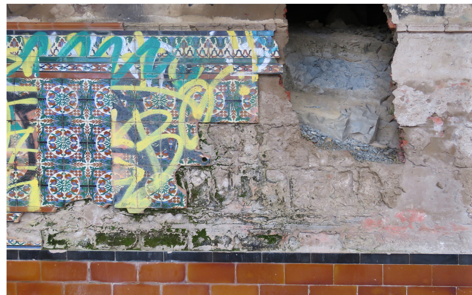
Figura 15 (dcha). Detalle de la zona desprovista de azulejos mostrando la división de estos en el mortero.
