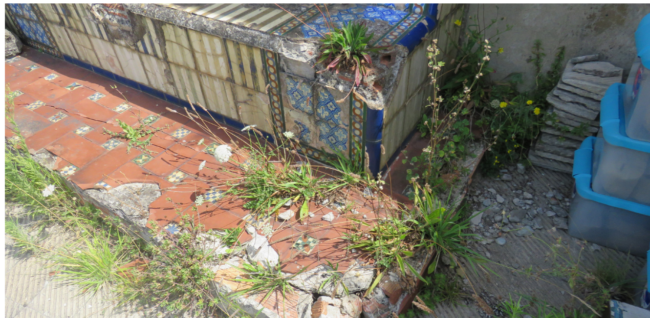
Figura 66 (abajo). Daño causado por afloramiento de plantas en banco y pavimento cerámico.
