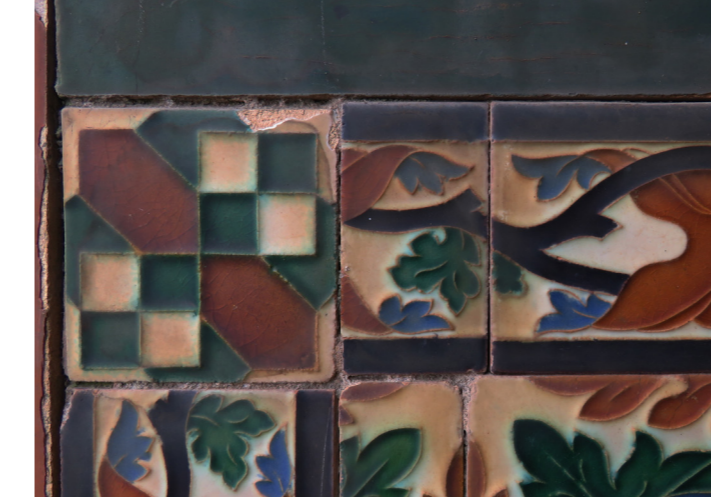
5. CONTAMINANTES ATMOSFÉRICOS (Figura 35).
