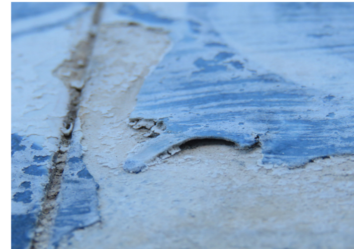
12. DISGREGACIÓN DEL VIDRIADO (Figura 42).
