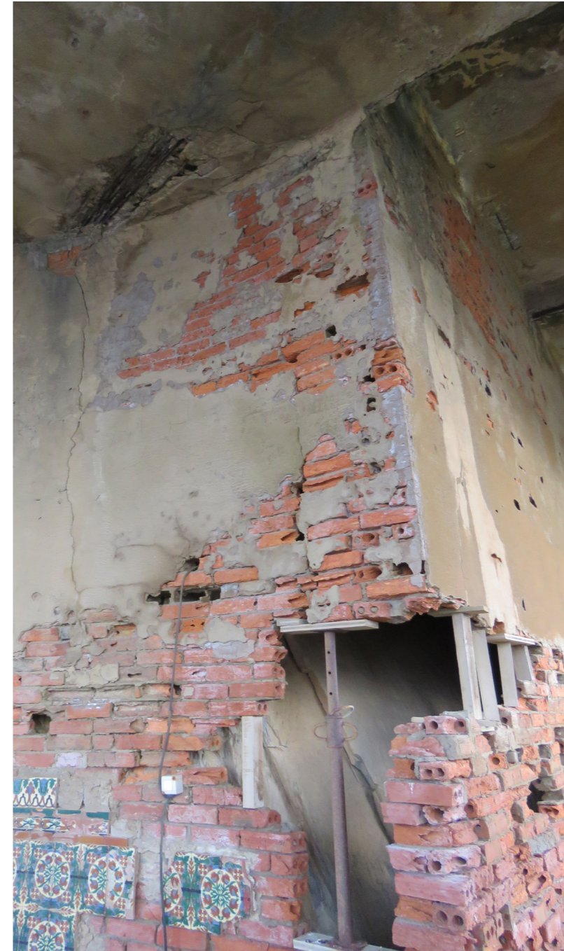
Figura 70 (izq.). Estado de la estructura del muro. Puntales para compensar la pérdida de ladrillos.
