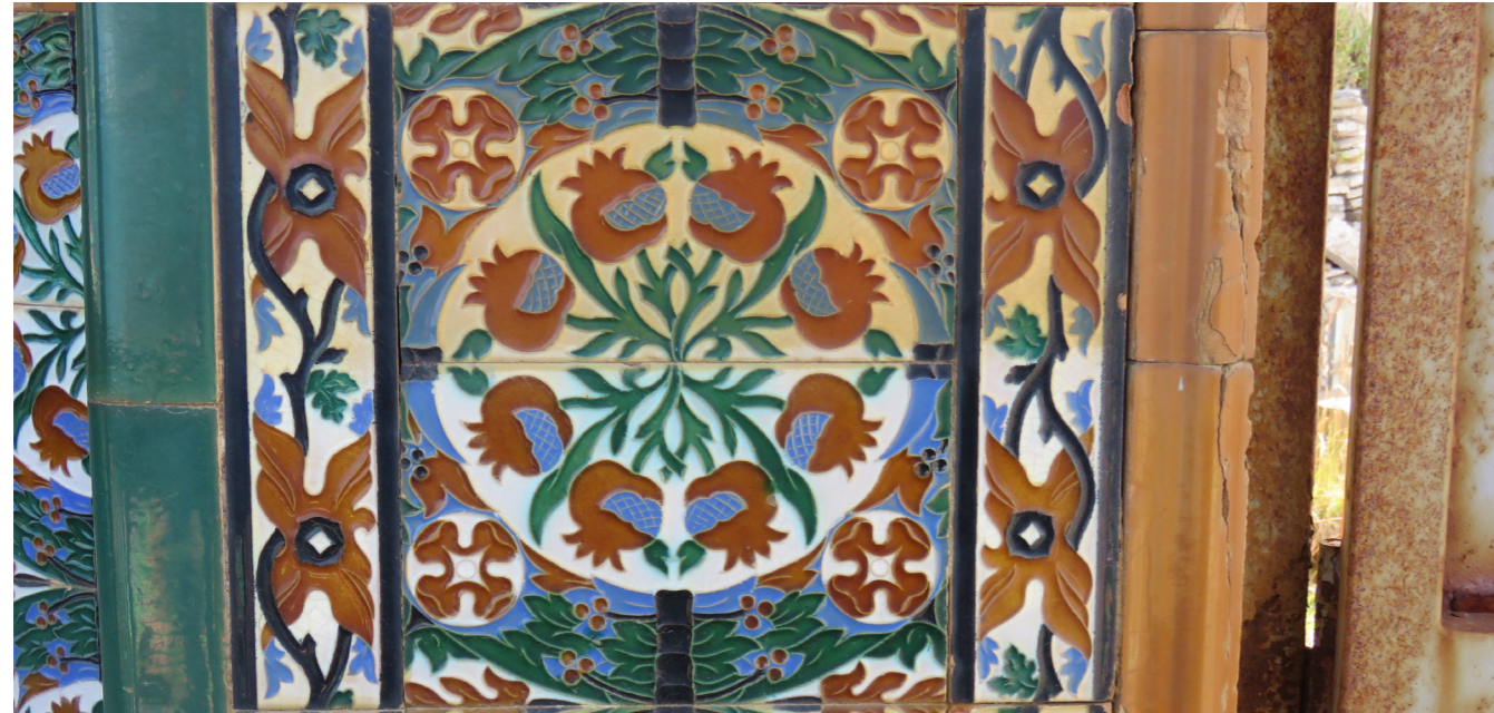
Figura 58. Superficie de azulejo con contaminantes atmosféricos (oxalatos) antes (arriba) y después (abajo) de la limpieza.
