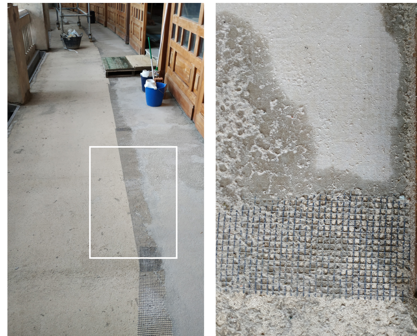
Figuras 137 y 138. Preparación de la superficie del suelo tras las labores de impermeabilización de la terraza. Superposición de capas de mortero y malla para mejorar el agarre.
