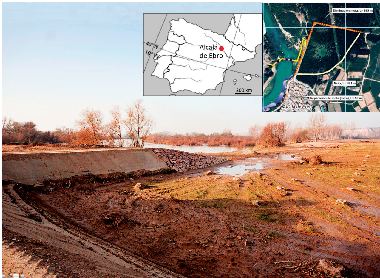
Fig. 3 – Zone où l'on a supprimé une digue à Alcalá de Ebro en 2015. Sur le croquis sur photo aérienne de la Confédération hydrographique de l'Èbre, la ligne de défense éliminée est marquée en pointillés
