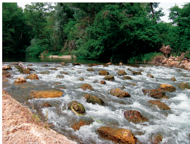
Fig. 8 – Rampe pour poissons dans le Najerilla (Torremontalbo, La Rioja)
