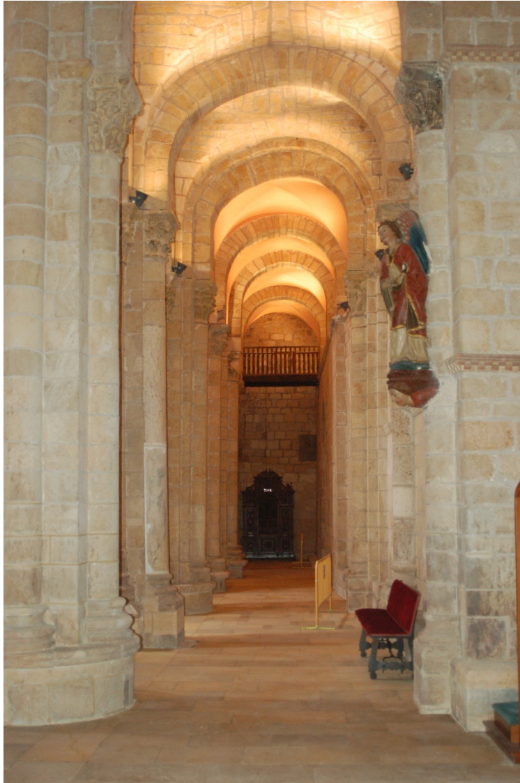
FIG. 15.4. VISTA HACIA EL OESTE DE LA NAVE LATERAL NORTE DEL AULA Y DEFORMACIÓN DE LOS ARCOS FORMEROS.
