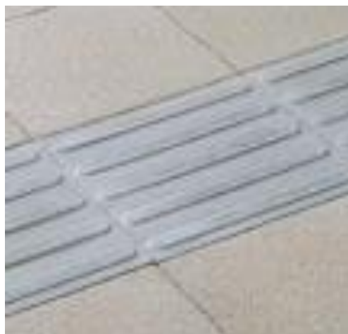
Figura 45. Pavimento a franjas
