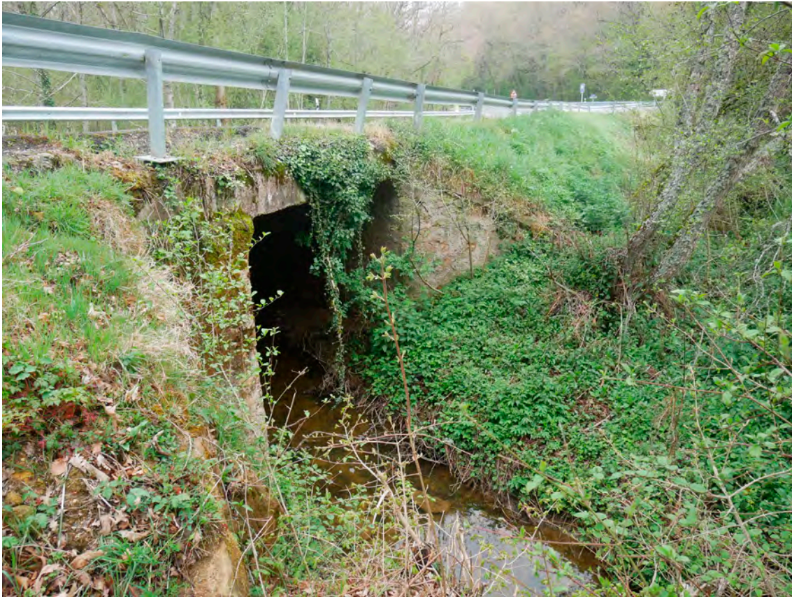
Ilustración 107: Tajea donde se puede apreciar la losa de hormigón y los estribos de mampostería.
