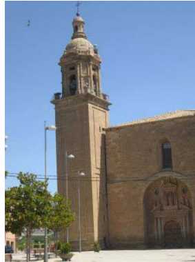
Entre la iglesia y la torre se abre una grieta de 40 centímetros. /P. H.
