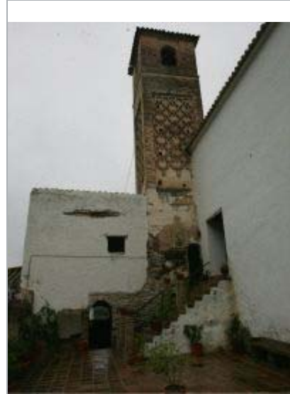
CAÍDA. La inclinación es leve, pero se aprecia claramente desde el patio interior.
