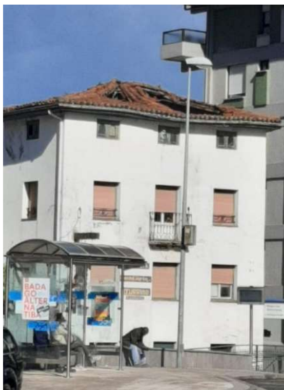
Imagen 34: tejado del edificio “bar Mendixa” cayéndose (elaboración propia)
