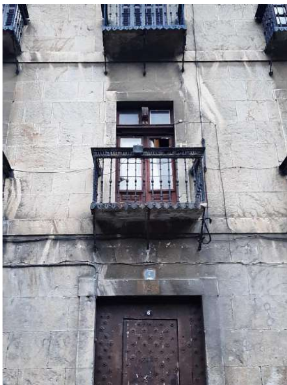
Imagen 22: ventana rota (elaboración propia)
