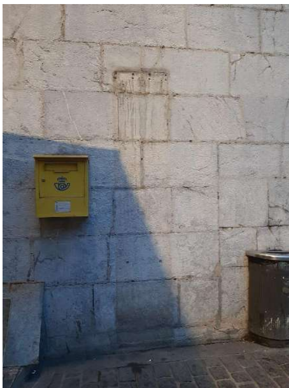
Imagen 36: fachada del ayuntamiento manchada (elaboración propia)
