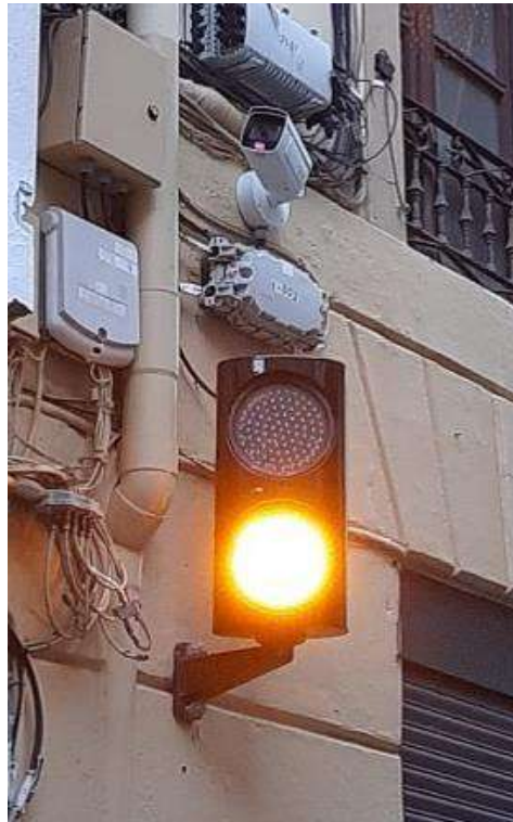
Imagen 13: semáforo junto con las CCTV que controlan los accesos a la plaza (elaboración propia)
