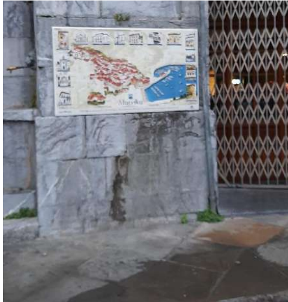
Imagen 37: fachada de la oficina de información manchada (elaboración propia)
