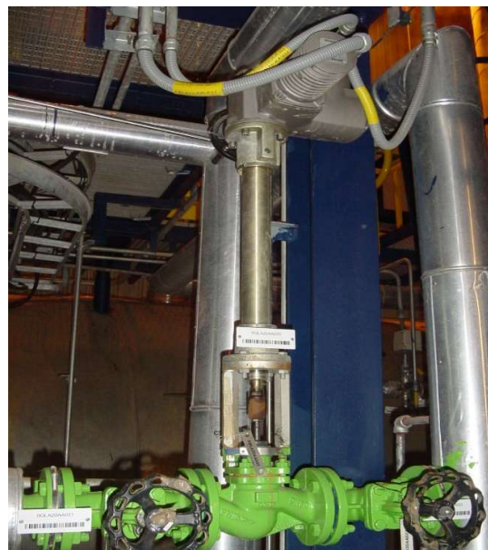
Válvula de control de nivel de la caldera auxiliar
