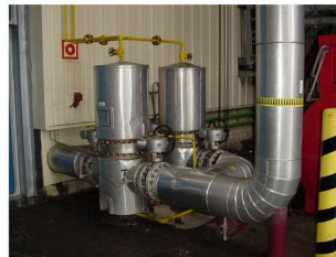
Filtros de gas
