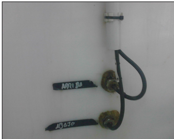
Figura 35. Transductor de temperatura (PT100) de la cuba. (Fuente: Empresa atunera: Pesquería Vasco Montañesa) [13]
