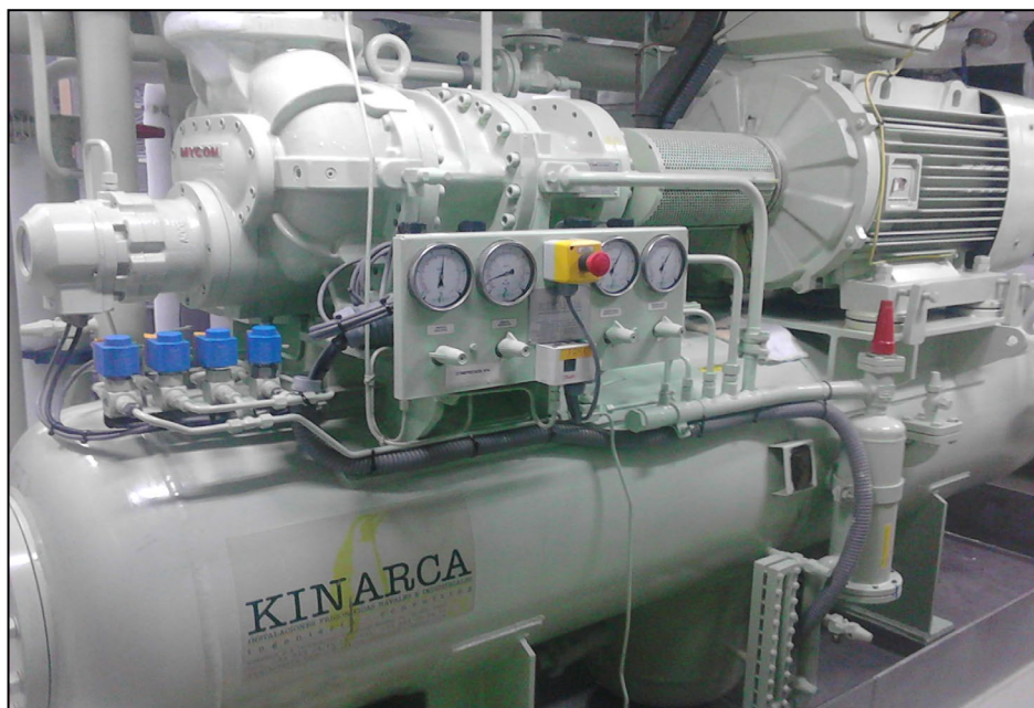
Figura 14. Imagen general del compresor (Fuente: Empresa atunera: Pesquería Vasco Montañesa) [13]
