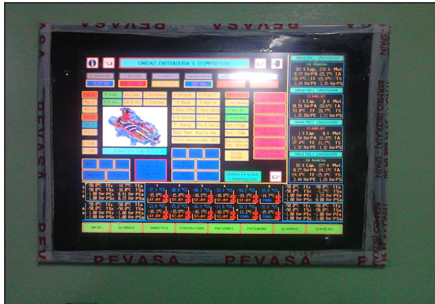
Figura 28. SCADA para el control de las unidades enfriadoras y temperaturas de las cubas.
