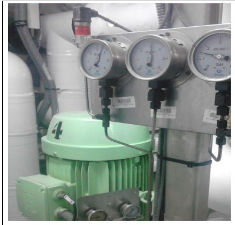
Figura 24. Bomba de Cloruro Cálxico y manómetros antes/después filtro (Fuente: Empresa atunera: Pesquería Vasco Montañesa) [13]
