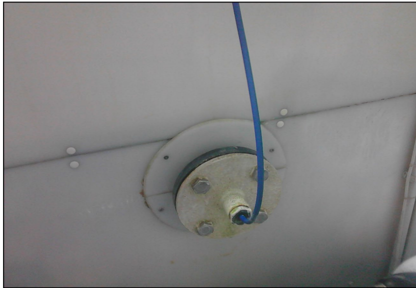
Figura 34. Transductor de presión / nivel de la cuba. (Fuente: Empresa atunera: Pesquería Vasco Montañesa) [13]
