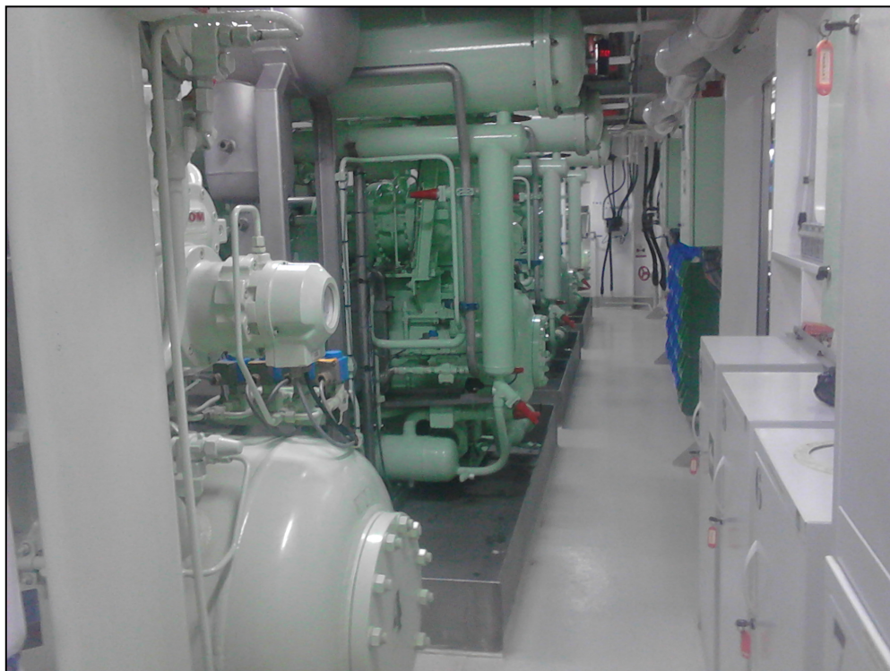
Figura 9. Local de la instalación frigorífica
