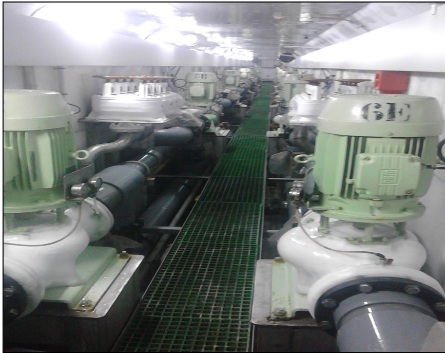
Figura 36. Bombas y tuberías de trasiego de salmuera y agua del mar.
