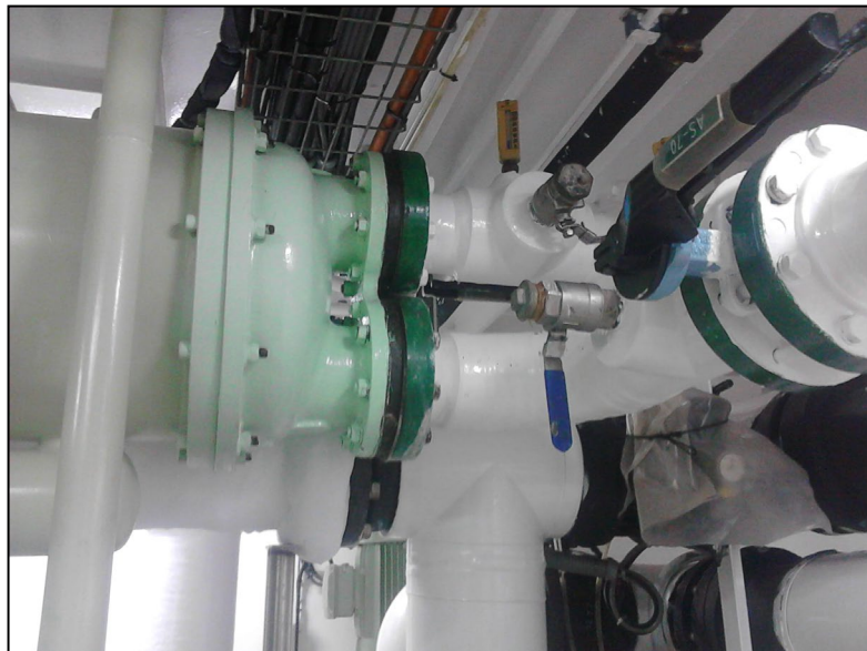
Figura 22. Condensador. Entrada/Salida agua salada. (Fuente: Empresa atunera: Pesquería Vasco Montañesa) [13]
