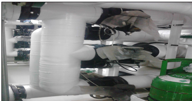
Figura 25. Electroválvulas neumáticas de comunicación unidad enfriadora y líneas (Fuente: Empresa atunera: Pesquería Vasco Montañesa) [13]
