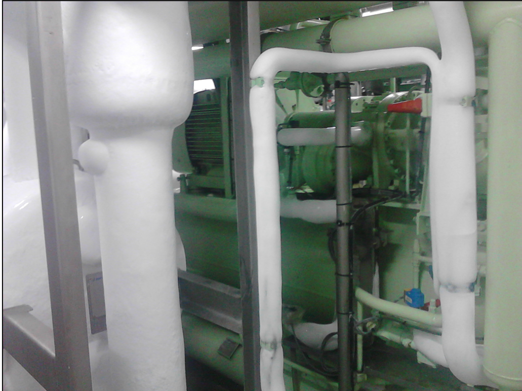
Figura 12. Instalación en funcionamiento / Hielo formado (Fuente: Empresa atunera: Pesquería Vasco Montañesa) [13]
