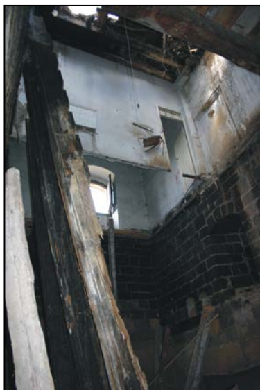
Img. 1.13. Derrumbe en la zona C
