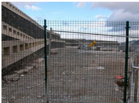
En su estado actual, el gran dique no solo está inconcluso, al igual que todo el recinto adyacente esta sin ser rematado urbanísticamente, con unas obras paralizadas, lo que confiere a este espacio un aspecto de abandono. Agosto 2013, márgenes del dique con obras paralizadas desde 2009.
