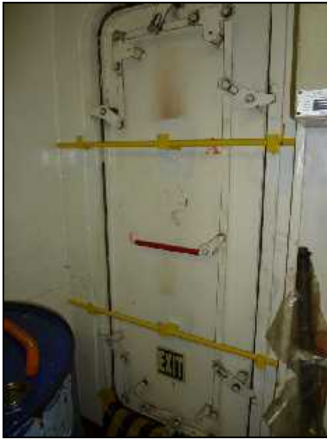
Figura 22. Sistema de barras para asegurar una de las puertas.
