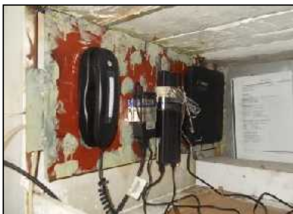
Figura 35 Teléfono instalado en la ciudadela.
