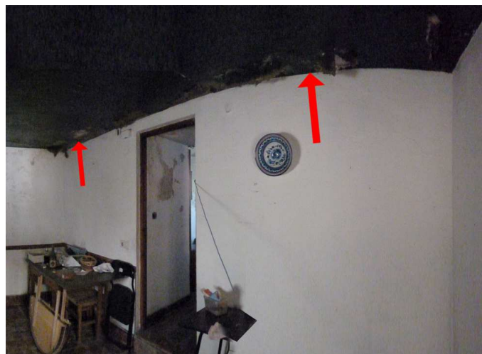
Figura 67. Eflorescencias en el techo de la cocina
