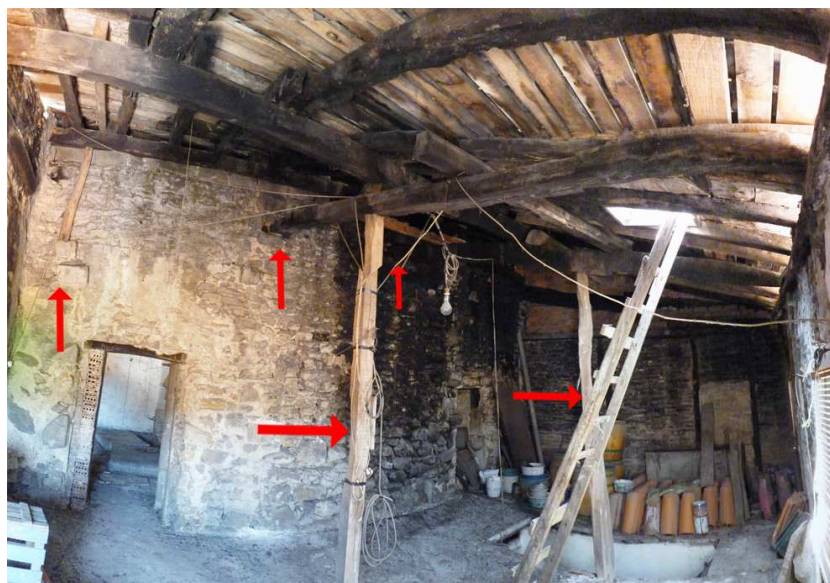
Figura 73. "Ganbara" del Palacio. Fallos en el apoyo y apuntalamientos
