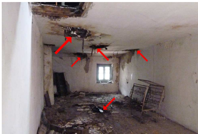
Figura 64. Daños causados por hongos de pudrición en la parte meridional
