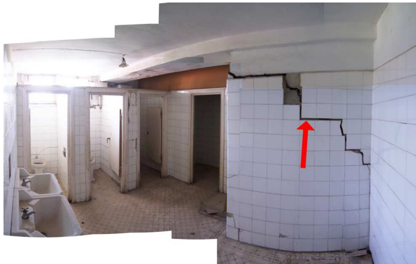
Figura 75. Grieta en uno de los tabiques de los aseos
