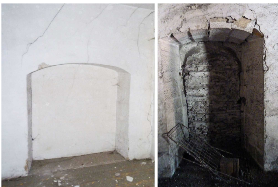
Figura 3. Pasos interiores tapiados en la planta superior.
