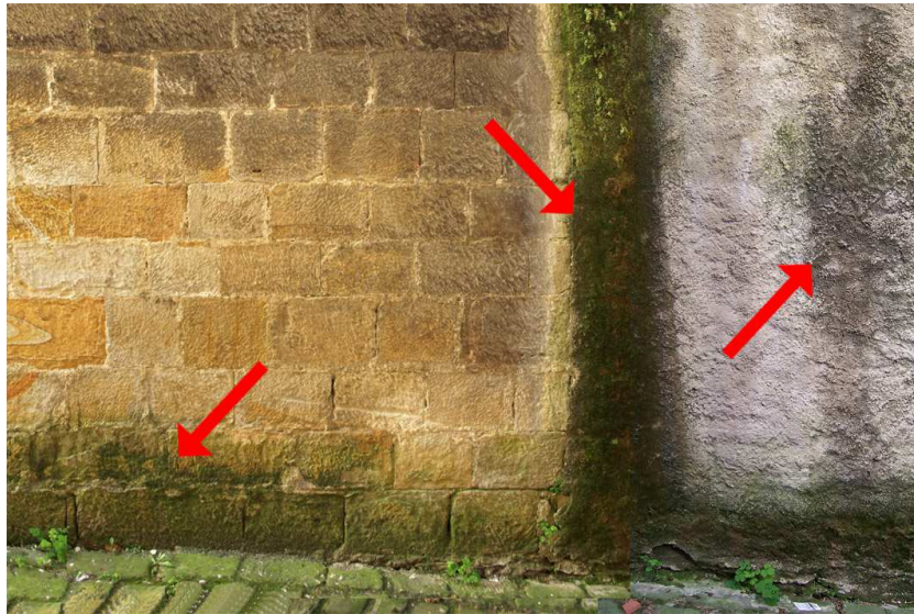
Figura 62. Microorganismos y humedades en la fachada lateral
