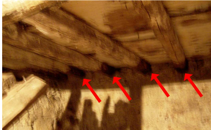
Figura 66. Presencia de humedad en los rollizos del sótano
