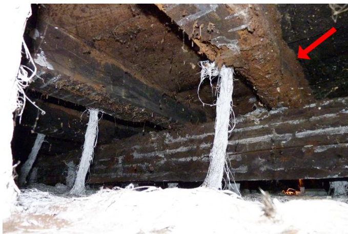
Figura 65. Daños producidos por anóbidos en techo del salón
