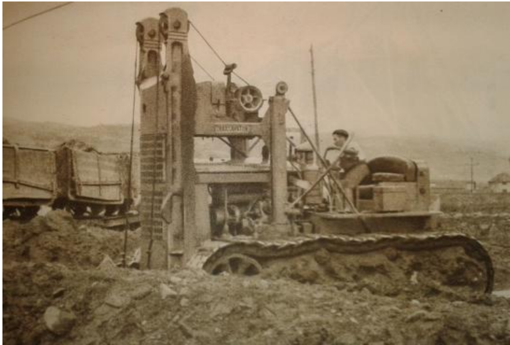
Alimentando el cargadero de la cinta transportadora
