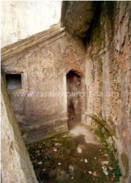
Figura 69. Puerta bajo la escalera de subida al 2º piso, torreón de Vista Alegre
