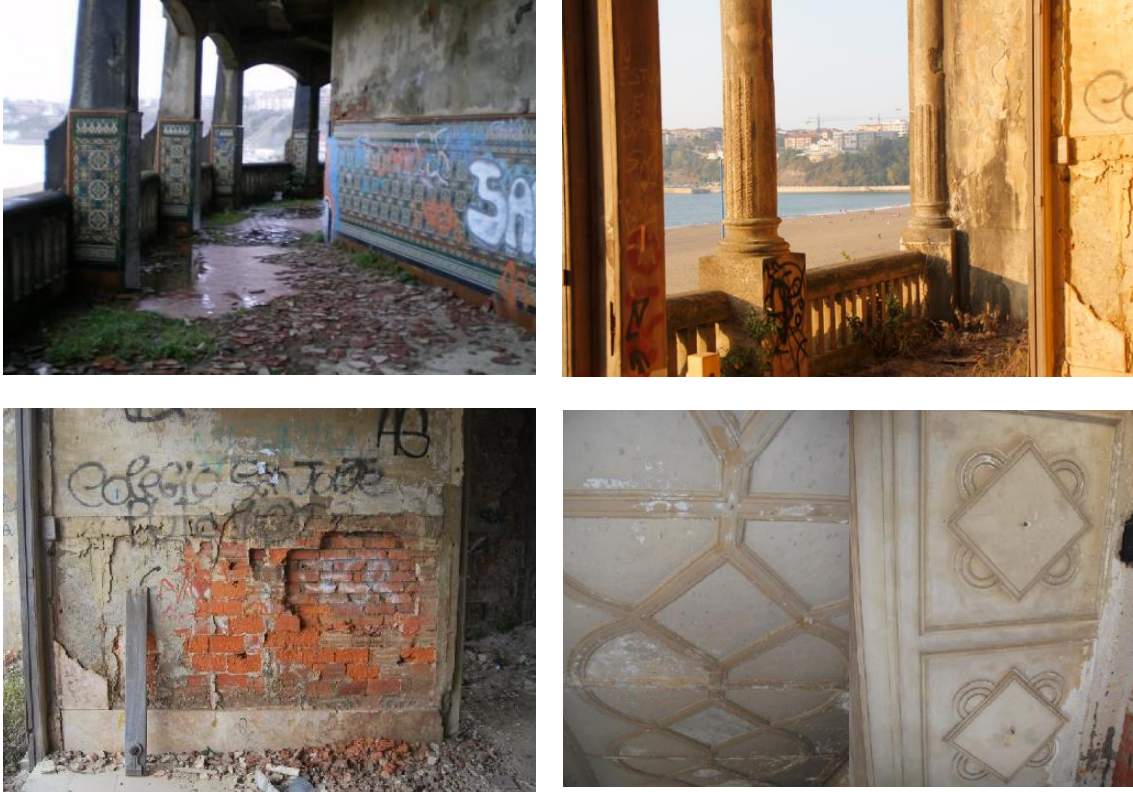
Figura 45. Estado actual de la galería, los tabiques y el techo de escayola
