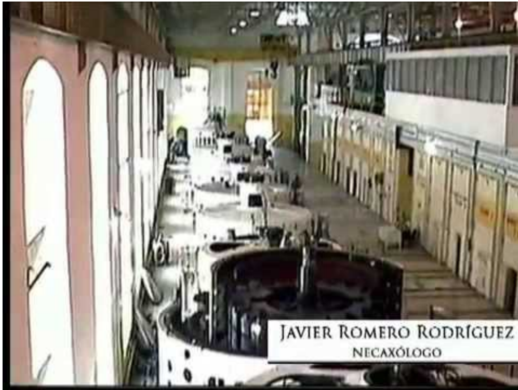
Casa de máquinas. Planta Necaxa
