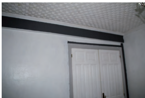
FIGURA A19. 29. VIGA EN VIVIENDA DE 1º PLANTA
