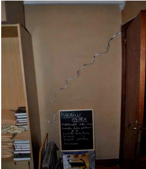
FIGURA A9. 43. GRIETAS EN TABIQUES EN 1º IZQUIERDA 9
