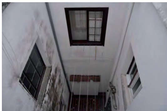
FIGURA A3. 44. MANCHAS DE HUMEDAD EN UNO DE LOS PATIOS 7
