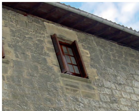
FIGURA A17. 42. SILLARES DE ARENISCA EN TORNO A HUECO DE SEGUNDA PLANTA
