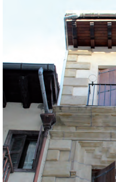
FIGURA A7. 29. BAJANTE DE PVC Y METÁLICA
