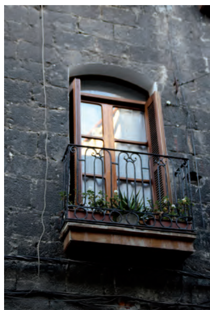
FIGURA A2. 36. HUECO EN FACHADA PRINCIPAL
