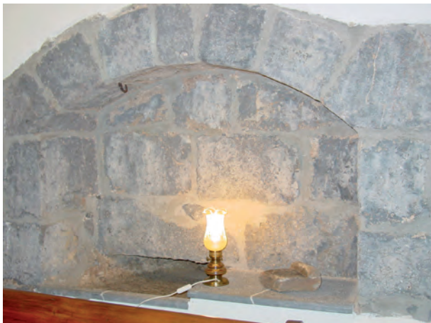
FIGURA A17. 5. HUECO INTERIOR EN MURO DE FACHADA
