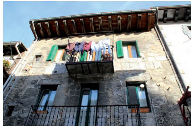
FIGURA A6. 38. ANCLAJES EN DESUSO
