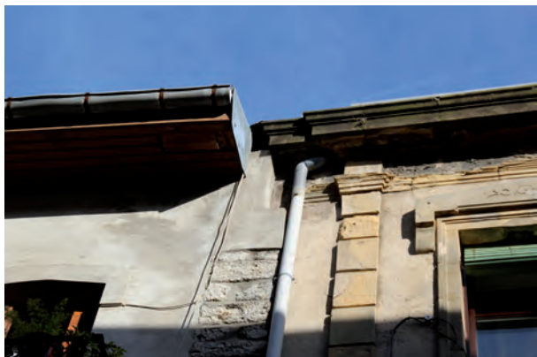
FIGURA A14. 13. BAJANTE EN FACHADA PRINCIPAL
