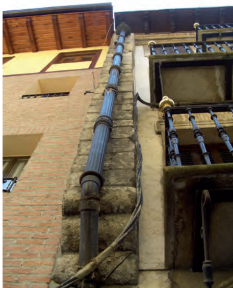
FIGURA A4. 36. BAJANTE POR MURO MEDIANERO
