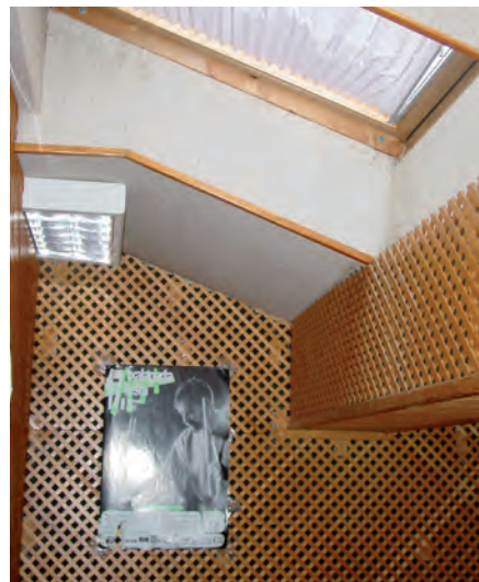
FIGURA A18. 35. CONDENSACIONES EN PLANTA BAJOCUBIERTA
