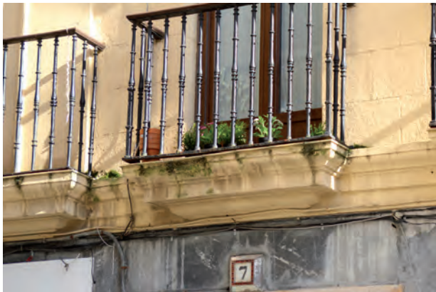
FIGURA A20. 41. VOLADIZO CON MANCHAS
