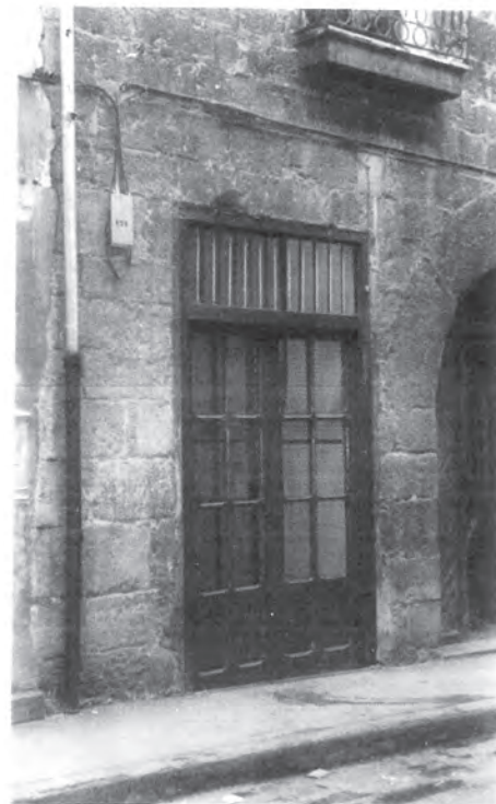
FIGURA A2. 23. PUERTA DE ACCESO
