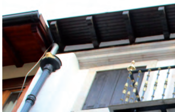
FIGURA A4. 37. CANALÓN OCULTO Y BAJANTE
