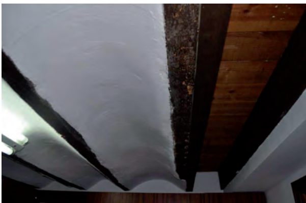
FIGURA A3. 18. FOTOGRAFÍA DE FORJADO ORIGINAL REFORZADO 4
