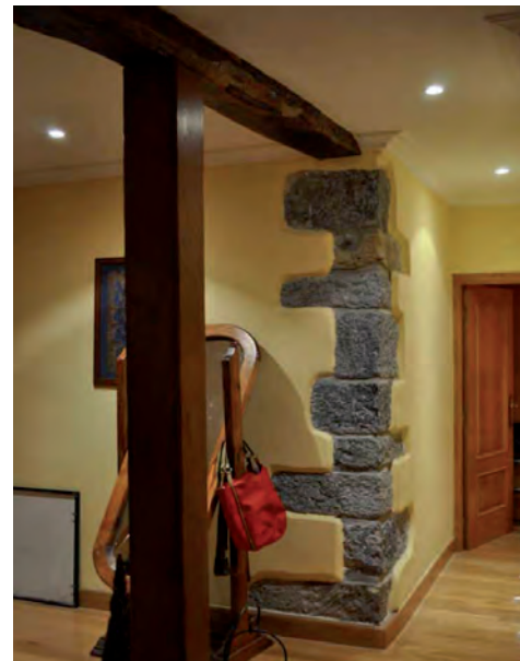
FIGURA A9. 42. PILAR UBICADO EN 3º IZQ 8
