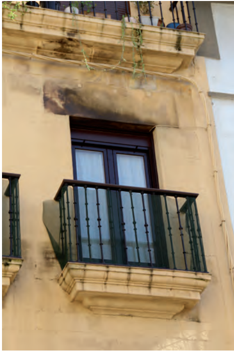
FIGURA A20. 39. DINTEL ENNEGRECIDO EN FACHADA PRINCIPAL
