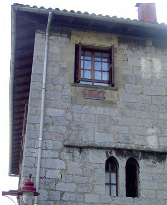
FIGURA A17. 47. GRIETA VERTICAL
