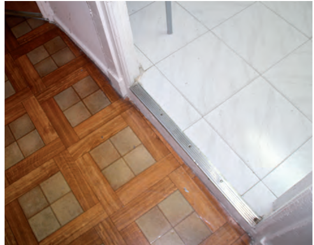
FIGURA A10. 36. ESCALÓN EN ACCESO A COCINA
