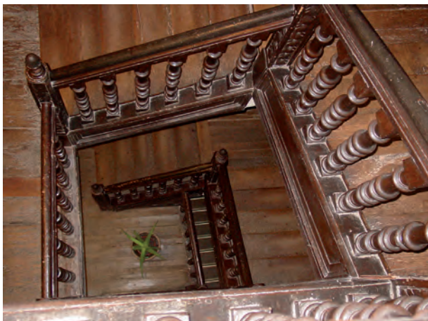
FIGURA A20. 43. HUECO EN CAJA DE ESCALERAS
