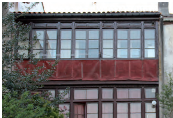
FIGURA A14. 14. CANALÓN EN FACHADA TRASERA
