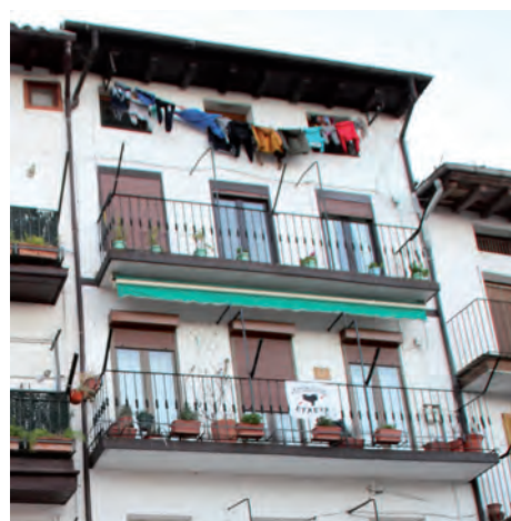
FIGURA A16. 22. BAJANTES EN FACHADA TRASERA
