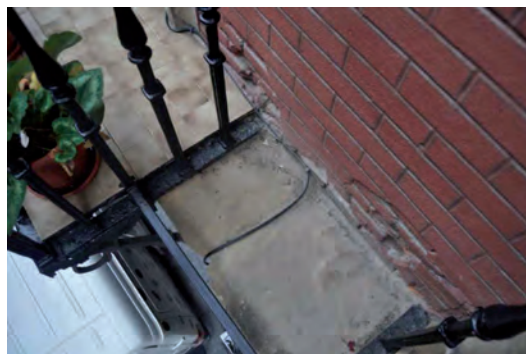
FIGURA A3. 45. FACHADA PRINCIPAL. REVOCO ESGRAFIADO IMITANDO APAREJO DE LADRILLO. DEGRADACIÓN PUNTUAL 8
