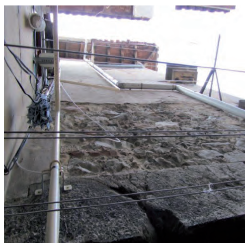
FIGURA A13. 48. RASEO DESPRENDIDO EN FACHADA A PLAZA BERRI CON ARMADURAS OXIDADAS AL AIRE
