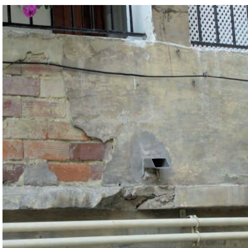
FIGURA A13. 49. RASEO DESPRENDIDO EN FACHADA A PATIO ESTE
