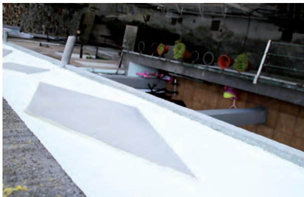
FIGURA A10. 25. MURETE DE BALCÓN EN FACHADA TRASERA DE 3ª PLANTA
