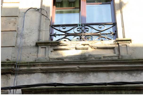
FIGURA A14. 20. HUECO EN FACHADA PRINCIPAL
