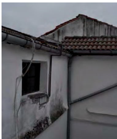
FIGURA A3. 52. VISTA PARCIAL DE LA CUBIERTA. ENCUENTRO ENTRE FALDÓN Y MEDIANERA DE PROPIEDAD COLINDANTE CON RECRECIDO DE MORTERO. ACUMULACIÓN DE SUCIEDAD. CABLEADO DESPROTEGIDO E INSUFICIENTEMENTE SUJETO 15
