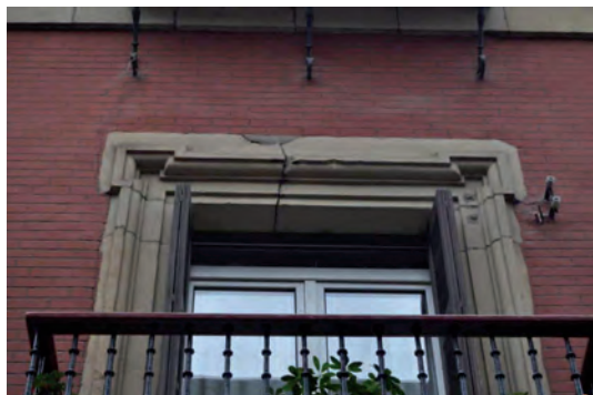
FIGURA A3. 46. 1ºD. PERDIDA DE MATERIAL EN LA PARTE SUPERIOR DEL DINTEL DE PIEDRA PARTIDO 9
