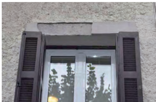
FIGURA A3. 48. FACHADA TRASERA. DESPRENDIMIENTO DE RECERCO DE MORTERO (50X20CM APROXIMADAMENTE) 11
