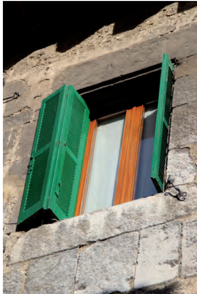
FIGURA A6. 39. HUECO EN FACHADA TRASERA
