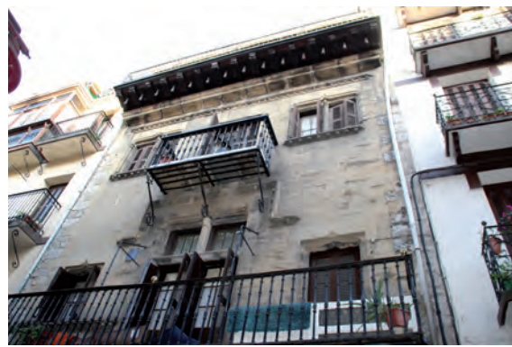
FIGURA A11. 26. MOLDURAS DESGASTADAS O DESPRENDIDAS
