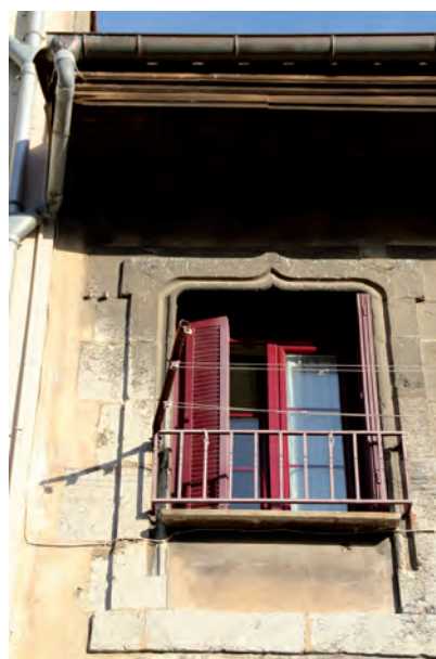
FIGURA A2. 37. HUECO EN FACHADA TRASERA
