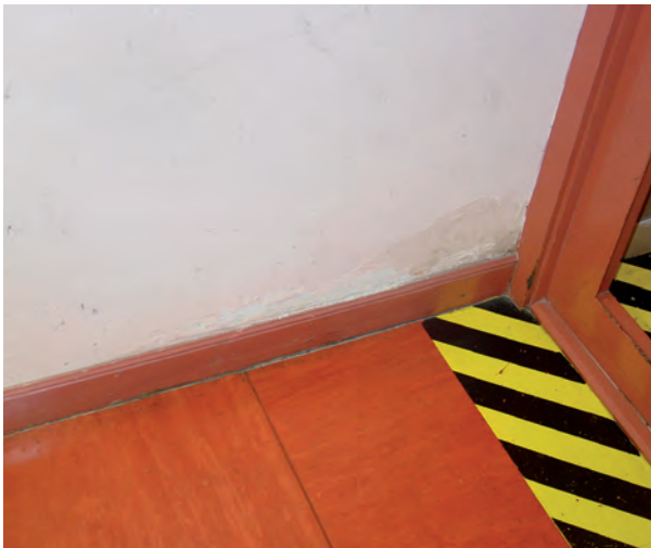
FIGURA A18. 42. HUMEDADES EN PARED
