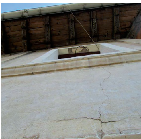
FIGURA A13. 47. AGRIETAMIENTO EN REVOCO DE FACHADA
