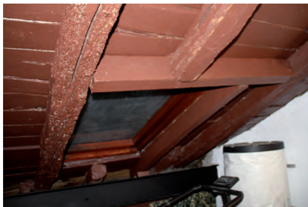
FIGURA A8. 30. HUECO EN CUBIERTA
