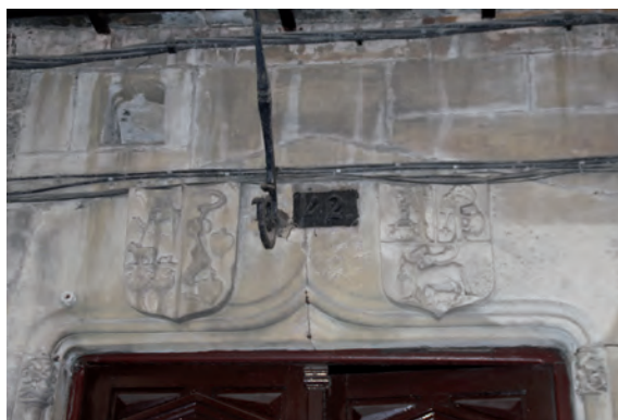
FIGURA A11. 24. GRIETA EN DINTEL DE PUERTA
