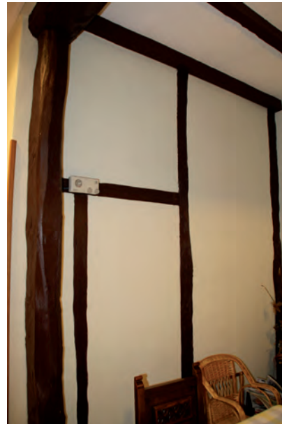
FIGURA A6. 28. MURO DIVISOR EN VIVIENDA
