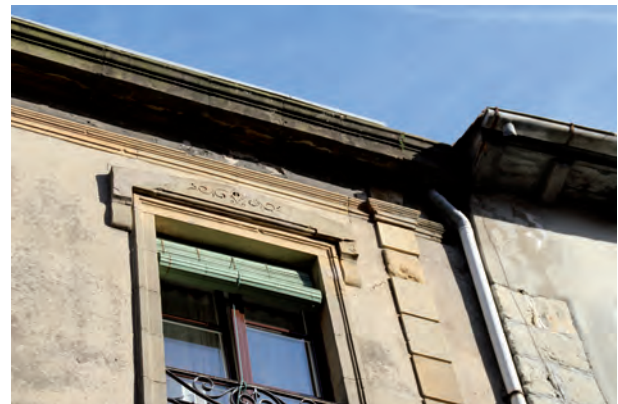
FIGURA A14. 19. HUECO EN FACHADA PRINCIPAL
