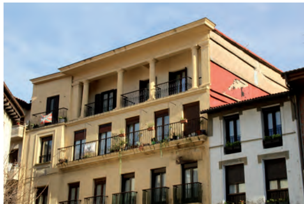
FIGURA A20. 38. DESCONCHAMIENTOS EN MURO MEDIANERO
