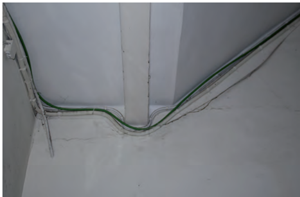
FIGURA A12. 36. INSTALACIONES ELECTRICAS EN ESCALERAS
