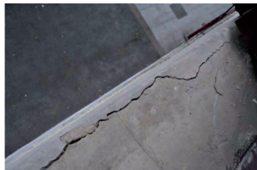
FIGURA A3. 49. VISTO EN EL 1ºB. AUSENCIA GENERAL DE PIEZA ESPECIAL PARA VIERTEAGUAS EN TODA LA FACHADA. GRIETA QUE AVISA DEL FUTURO DESPRENDIMIENTO DEL RECERCO DEL HUECO 12
