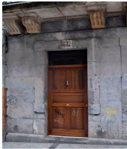
FIGURA A9. 52. ACCESO POR CALLE MAYOR. HUMEDADES EN MODILLONES DE PIEDRA DE BALCONES
