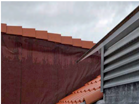
FIGURA A9. 54. FOTOGRAFÍA DE FALDÓN NORTE Y ENCUENTRO CON PARAMENTO VERTICAL 49
