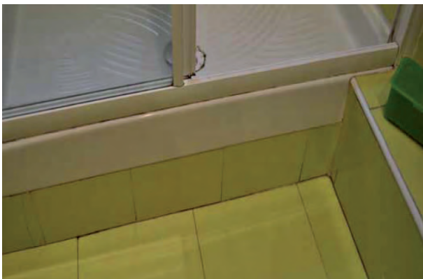
FIGURA A9. 45. ASEO DE 3º DERECHA. HUNDIMIENTO DE SUELO 10
