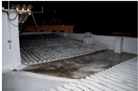
FIGURA A1. 52. CHIMENEAS Y ANTENA EN CUBIERTA
