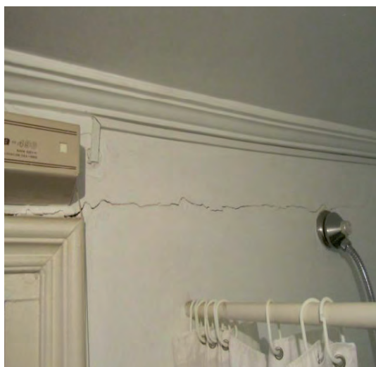
FIGURA A13. 43. FISURA HORIZONTAL EN TABIQUE DE ASEODE VIVIENDA DE 4º PISO
