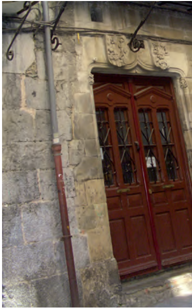
FIGURA A11. 31. BAJANTE EN FACHADA PRINCIPAL
