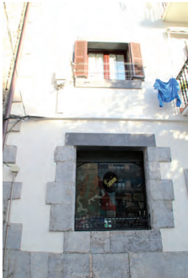
FIGURA A5. 34. HUECO EN FACHADA TRASERA
