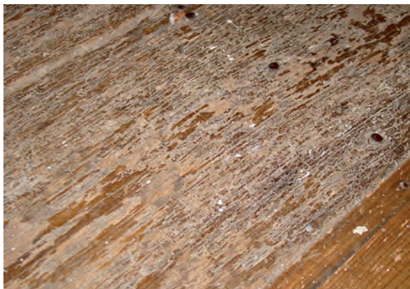
FIGURA A20. 33. TABLERO DE MADERA EN RELLANO
