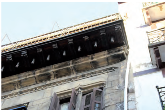
FIGURA A11. 25. MANCHAS EN CORNISA
