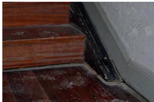
FIGURA A3. 43. DESPLAZAMIENTO DE SUELO EN LA PRIMERA MESETA DE LA ESCALERA. APERTURA DURANTE LAS OBRAS DE EJECUCIÓN DEL ASCENSOR 6
