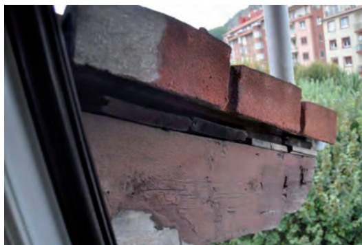
FIGURA A3. 51. VISTA DEL SOPORTE DE LA COBERTURA. TABLA DE MADERA COMBADA Y SIN TRABAZÓN POR ESTAR MUY EXPUESTA Y PADECER CON MAYOR INTENSIDAD CAMBIOS HIGROTÉRMICOS 14
