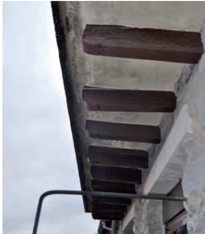
FIGURA A9. 49. CARA INFERIOR DE BALCON DE 4º PLANTA
