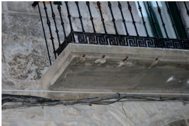
FIGURA A6. 37. CORROSIÓN EN VUELO DE FACHADA TRASERA
