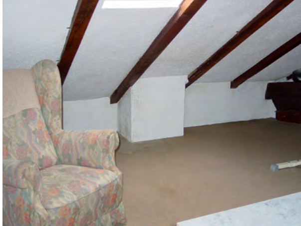
FIGURA A17. 49. MANCHAS DE HUMEDAD
