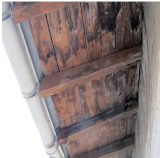
FIGURA A13. 52. HUMEDADES EN ALERO DE FACHADA ESTE
