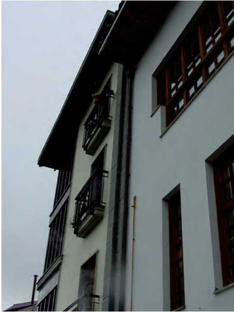
FIGURA A18. 40. BAJANTE FACHADA TRASERA
