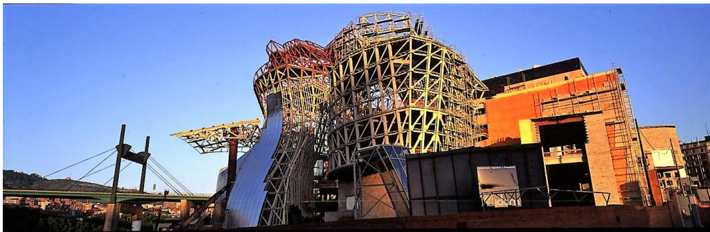
(fig.45) Vista de la construcción del edificio del Museo Guggenheim Bilbao con su entramado óseo de acero aún a la vista.
