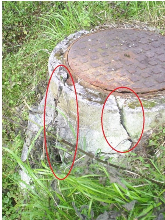
Figura 5: Demostración del mal estado de los filtros
