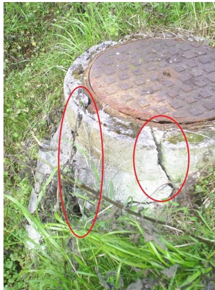
Figura 4: Grietas en filtro biológico en el barrio de Merika
