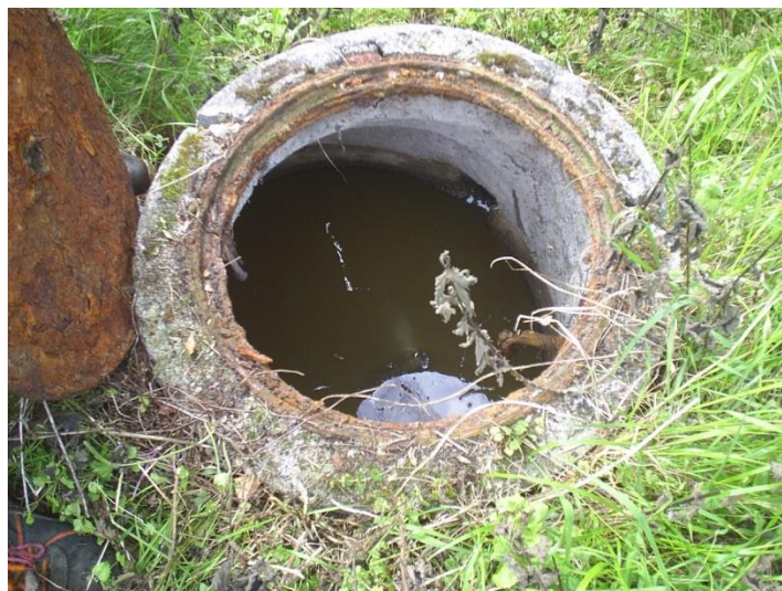
Figura 6: Interior del filtro biológico
