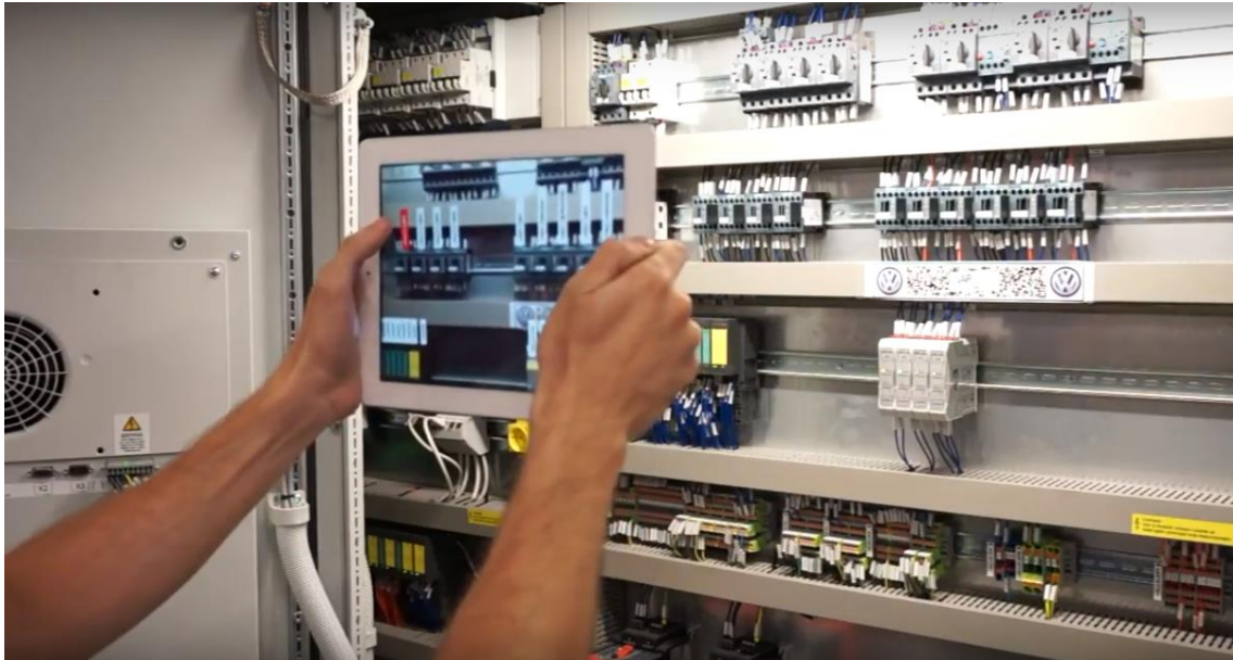
Figura 17. Realidad aumentada en armario eléctrico
