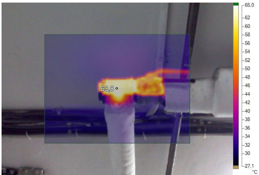
Fotografía 24: Termografía de válvula que hace de codo entre dos tuberías
