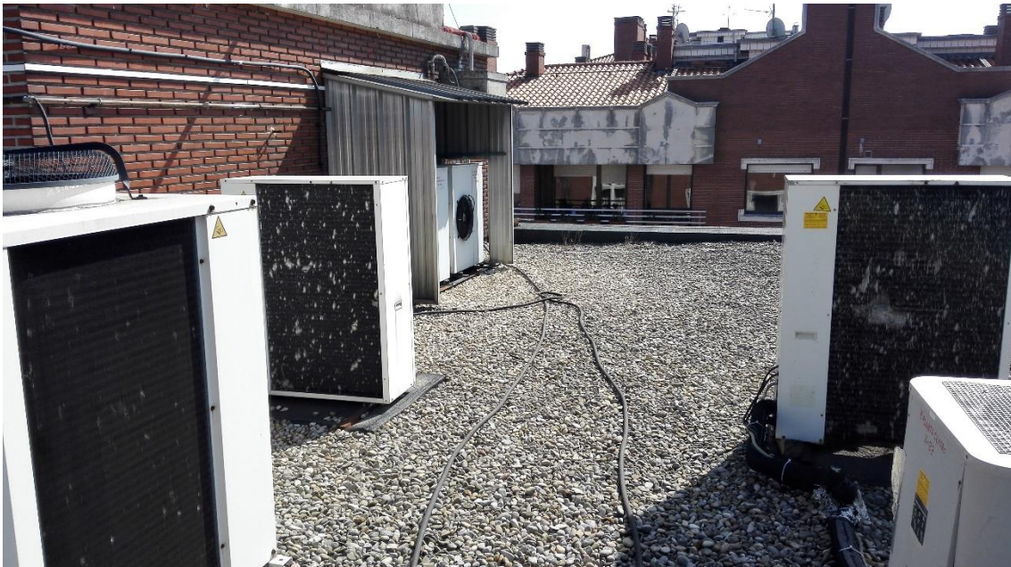
Fotografía 18: Unidades exteriores de la cubierta del edificio
