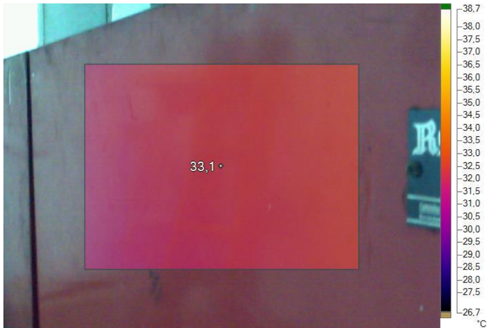
Fotografía 10: Termografía de la pared de la caldera
