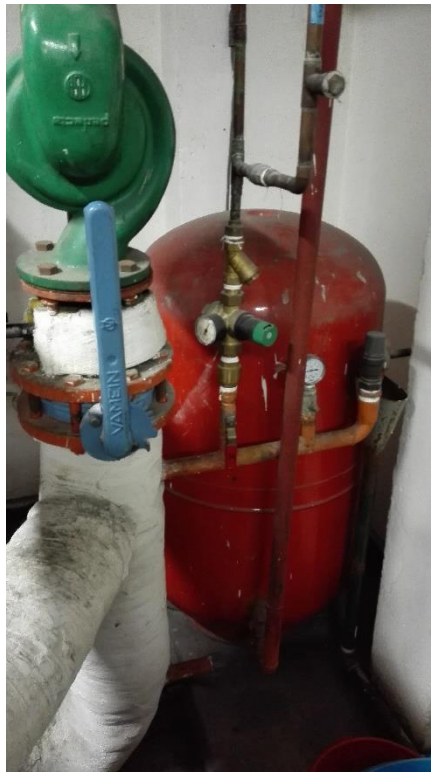
Fotografía 17: Depósito de expansión del agua
