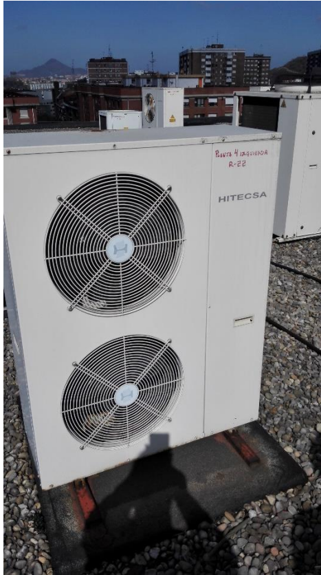
Fotografía 19: Unidad exterior ubicada en la cubierta
