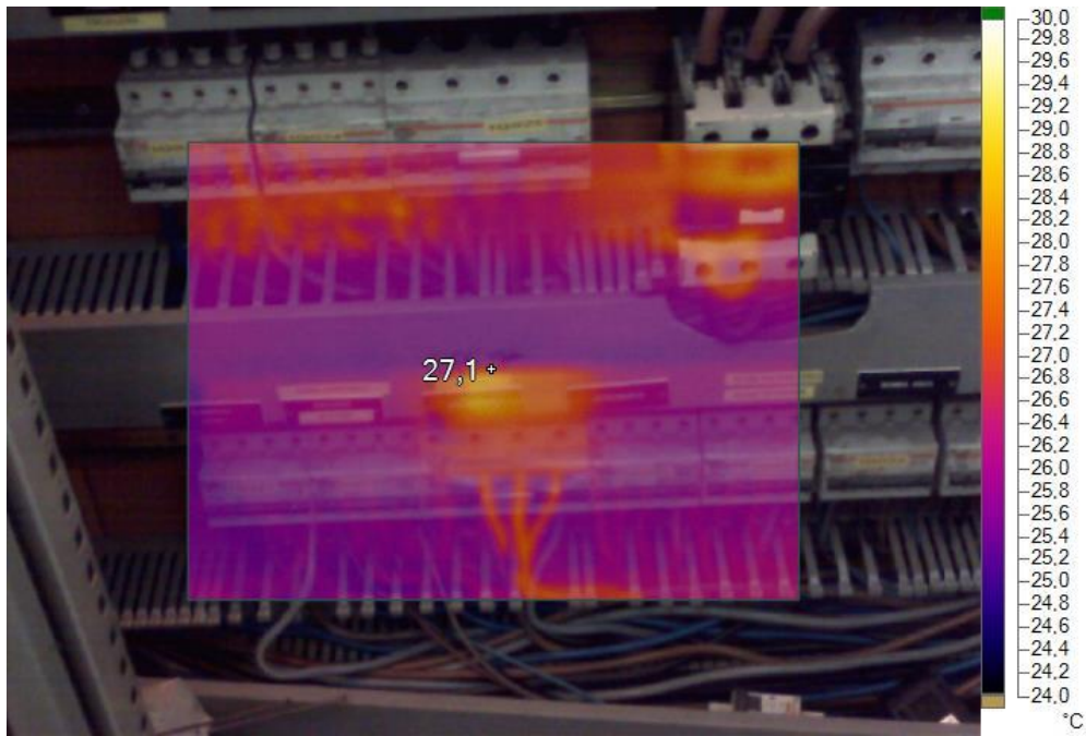
Fotografía 33: Termografía del cableado del cuadro eléctrico del edificio
