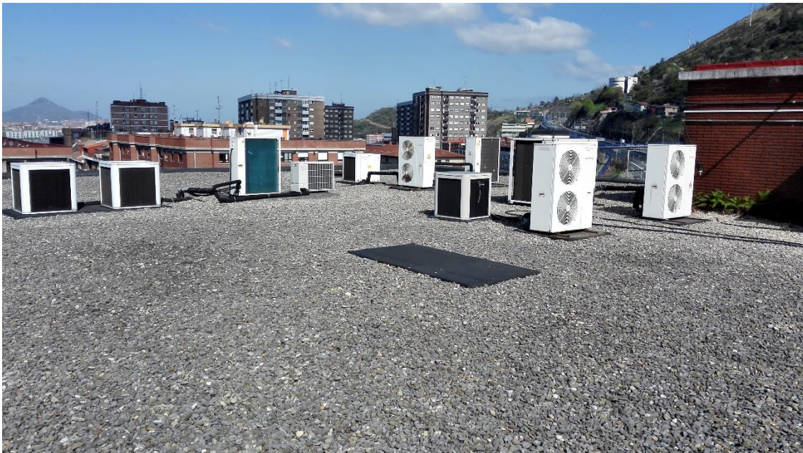
Fotografía 3: Unidades exteriores de la cubierta del edificio
