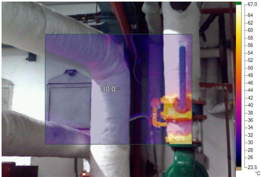
Fotografía 11: Termografía de las tuberías de paso del agua
