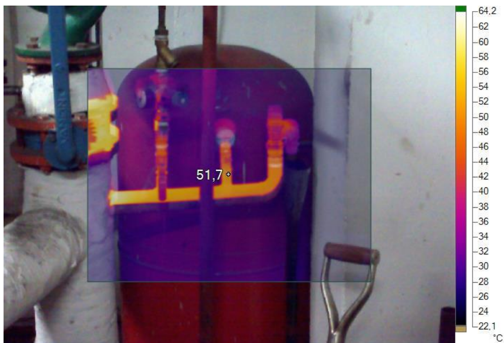
Fotografía 22: Termografía del depósito de expansión de agua y sus tuberías
