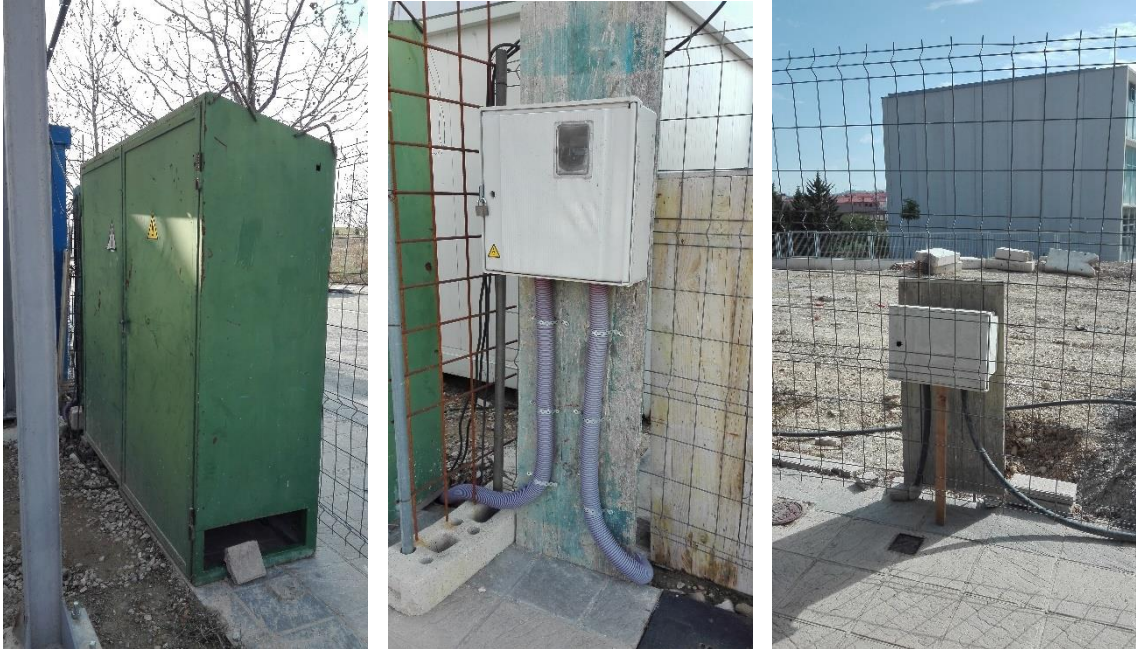
Argindarraren koadro orokorra (ezkerra) eta argindar eta ur kontagailuak (erdia eta eskuina)
