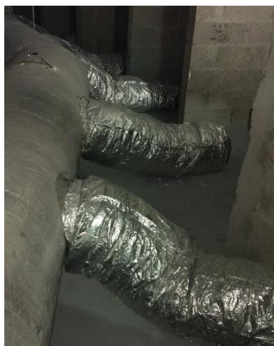
Figure 19: Soufflage d'air de la CTA sous les amphithéâtres
