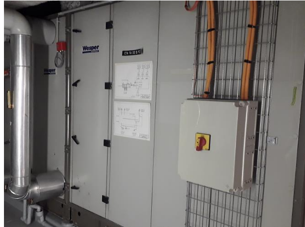
Figure 14: Interrupteur de proximité pour une CTA
