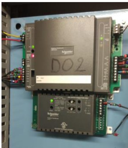
Figure 13: Un automate Infinet Controller
