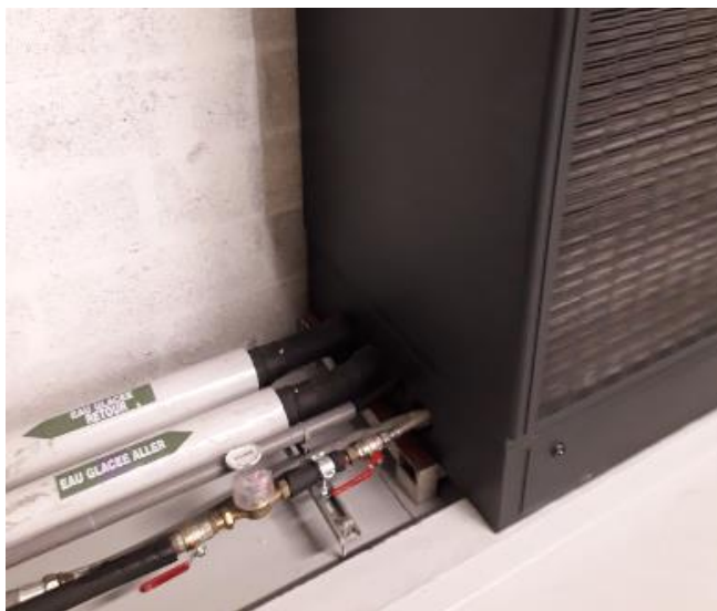
Figure 9: Compteur eau de ville d'une climatisation autonome
