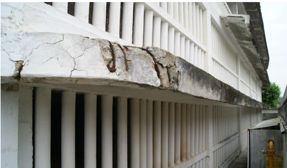
Fig. 3.382: Daños en el remate del alero de planta baja en la fachada sur. (Elaboración propia)
