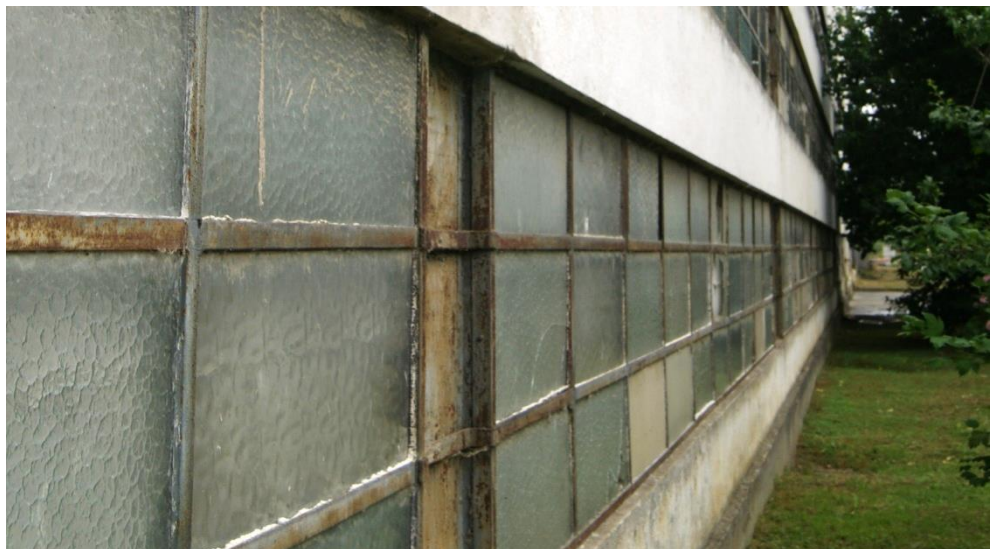
Fig. 3.284: Estado de las carpinterías del pabellón primitivo. 2016. (Elaboración propia)
