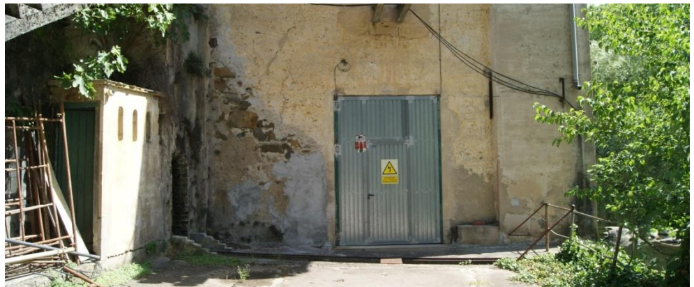
Fig. 3.313: Daños en el revestimiento de la fachada de acceso a la primitiva sala de turbinas. (Elaboración propia)
