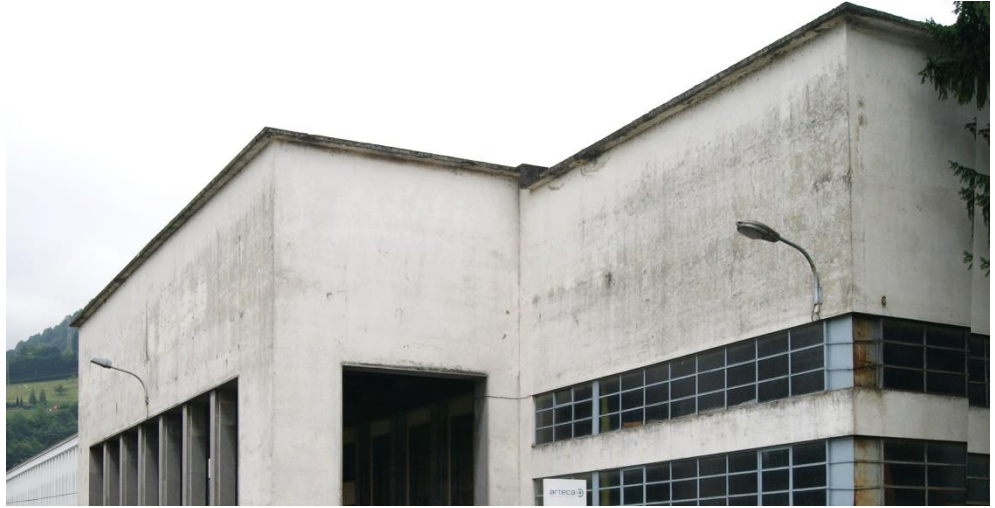
Fig. 3.281: Fachada principal donde se observan daños superficiales en el revestimiento. 2016. (Elaboración propia)
