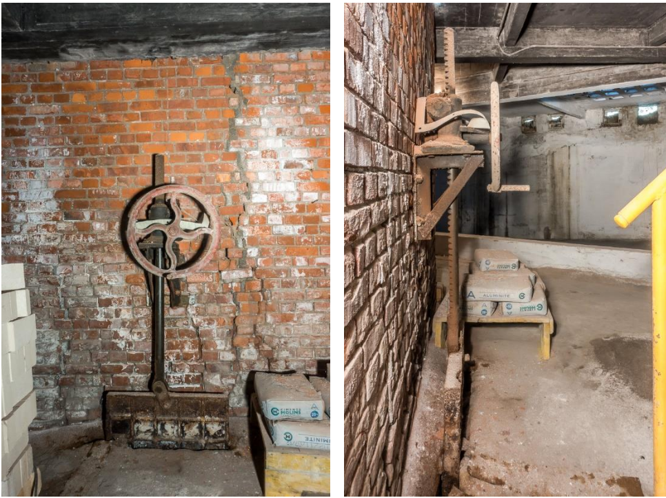
Fig. 3.373: Detalle de la compuerta que activa el tiro de la chimenea del horno 1 y 2. (Ana Vitoria)
