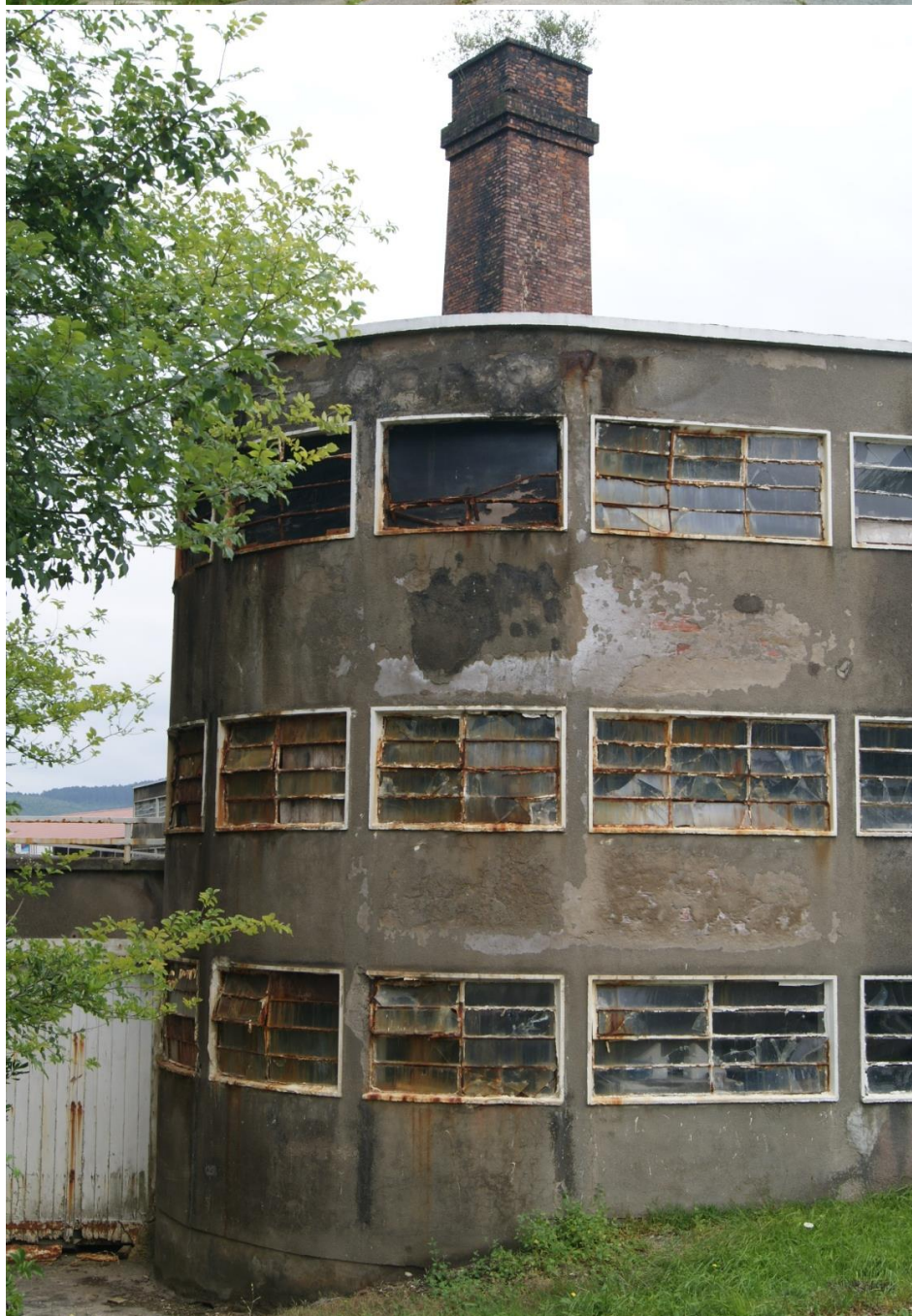
Fig. 3.379: Zona curvada de la fachada oeste que presenta mayor deterioro. (Elaboración propia)
