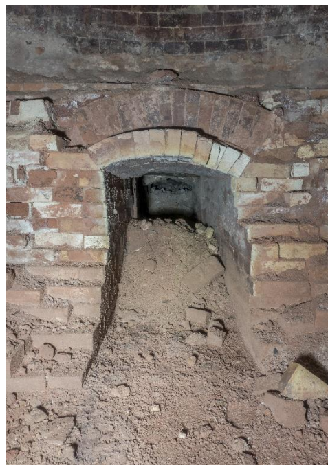
Fig. 3.370: Detalle de la estructura en la cámara inferior del horno 1 y detalle de la conexión con la galería que conduce los humos a la chimenea. (Ana Vitoria)
