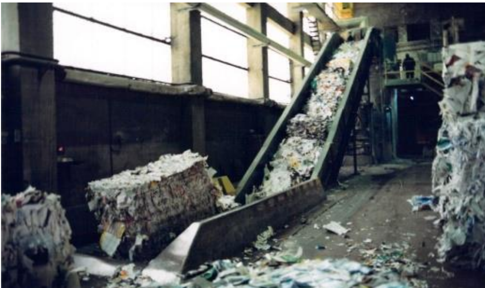
Fig. 3.181: Elevadora de la instalación de desfibrado para fardos de papel reciclado. (AEPE F 808)
