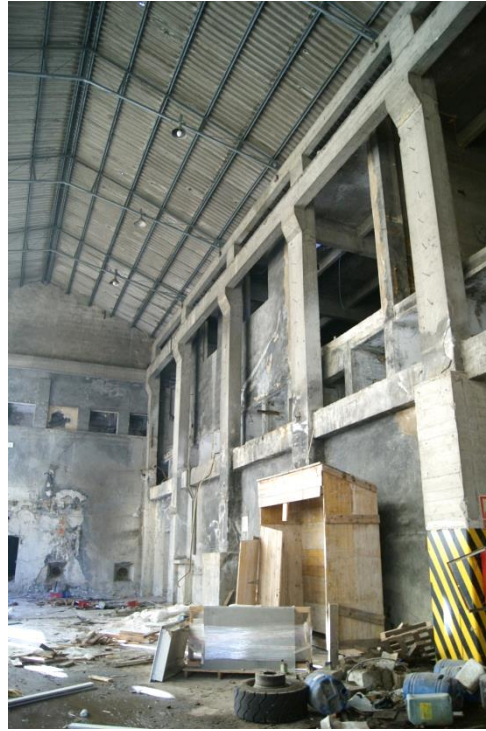
Fig. 3.187: Interior del espacio de la caldera y el espacio de doble altura junto al río en 2015. (Elaboración propia)
