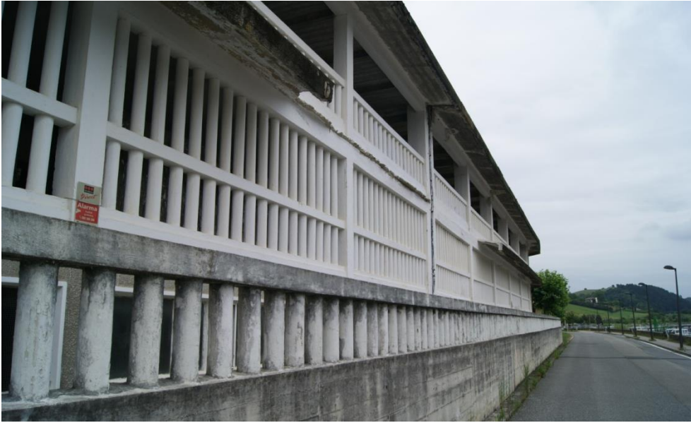
Fig. 3.380: Fachada sur de la nave donde ha desaparecido parte del alero. (Elaboración propia)
