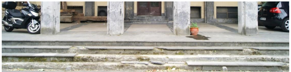
Fig. 3.282: Daños de las escaleras de la fachada principal. 2016. (Elaboración propia)
