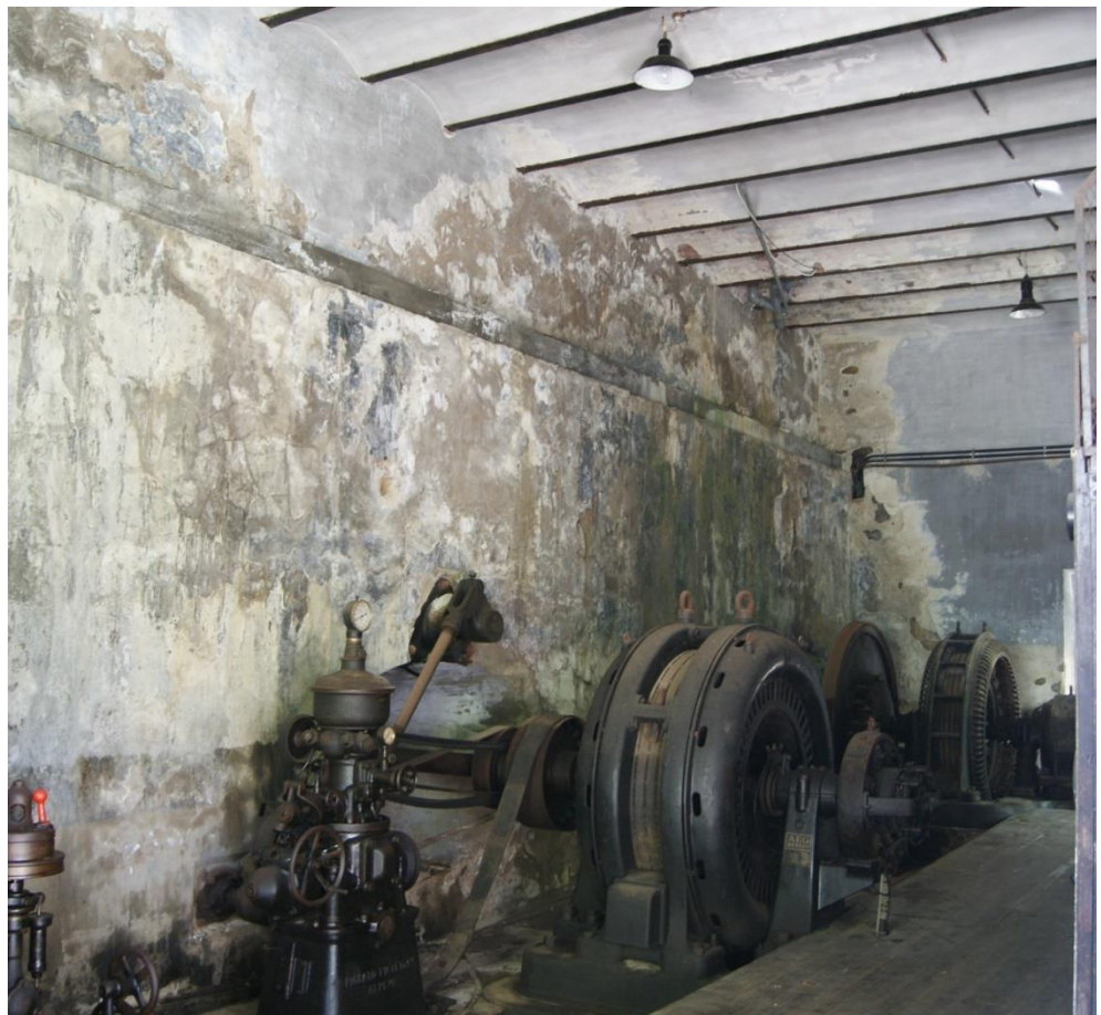
Fig. 3.314: Daños en el paramento de la primitiva sala de turbinas en contacto con la cámara de carga. (Elaboración propia)
