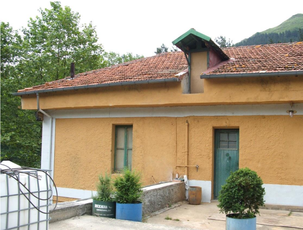
Fig. 3.303: Zona de acceso a la central donde se ve la mansarda actualmente desaparecida. (Gobierno Vasco)
