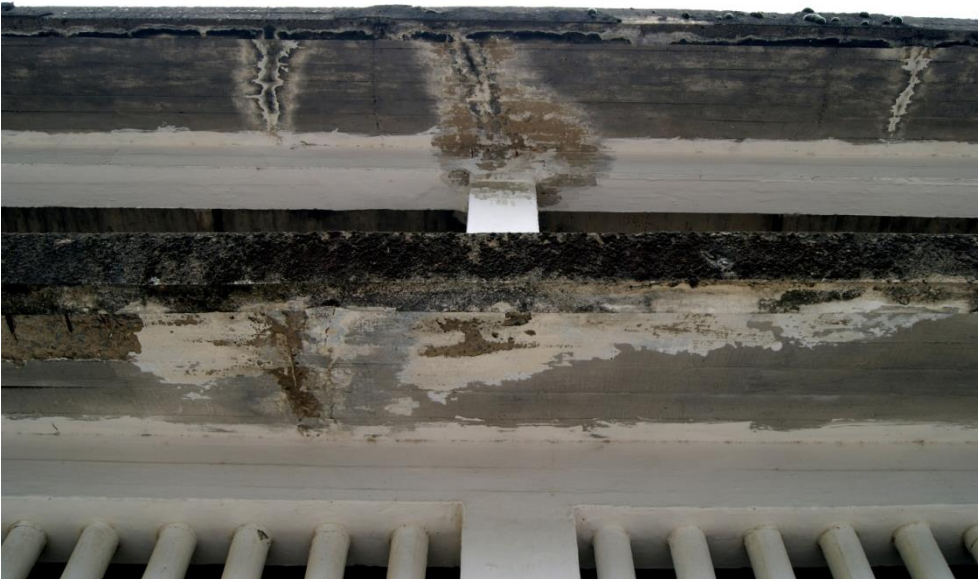
Fig. 3.381: Daños en los aleros de la fachada sur. (Elaboración propia)
