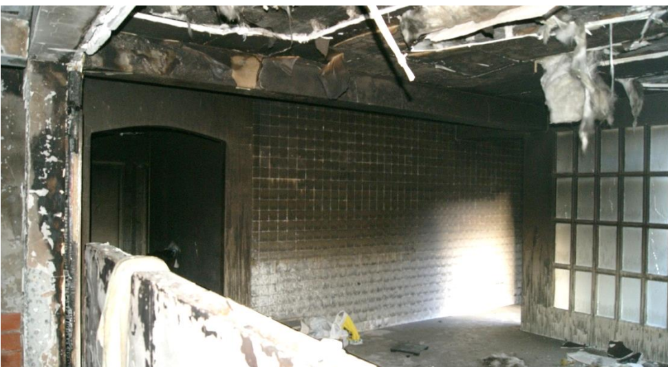
Fig. 3.193: Interior de la vivienda este en el edificio de vivienda y oficinas, tras el incendio, en 2015. (Elaboración propia)
