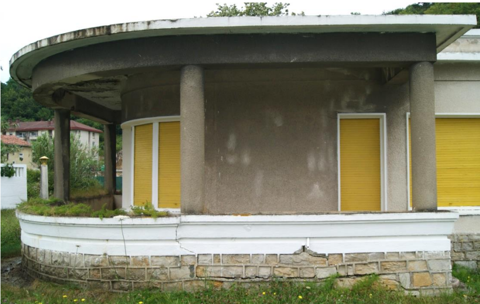
Fig. 3.375: Esquina sudoeste del edificio de oficinas donde presenta mayores daños. (Elaboración propia)
