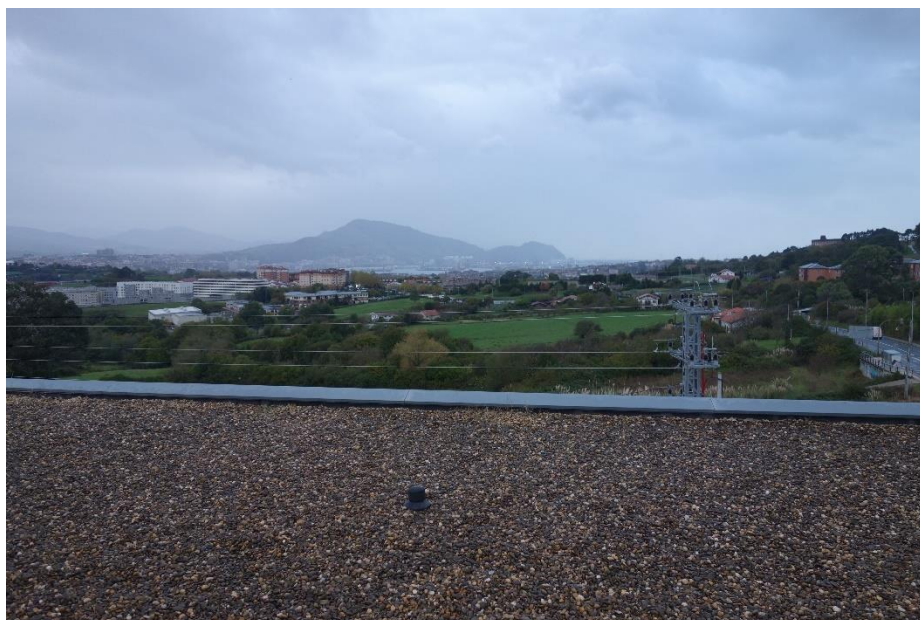
Imagen 5-2. Arista de la Facultad de Educación de Bilbao en la que Roseo ha instalado dos anemómetros. [17]
