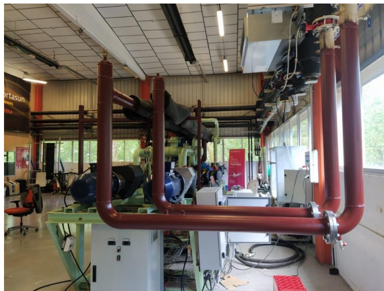
Figura 12 Adecuación de los anillos de frío y de calor a la bancada.
