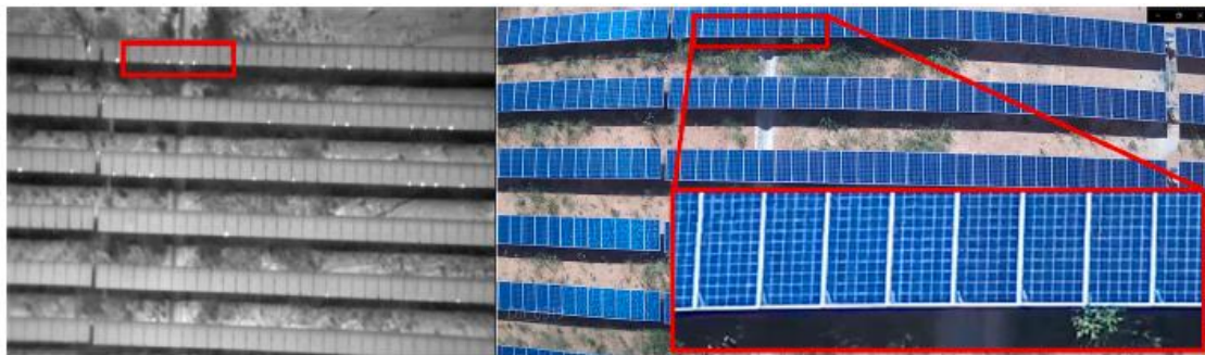
Figura 207. Patrón de suciedad creada por el viento sobre muchos módulos de c-SI tomadas con el sistema 2.
