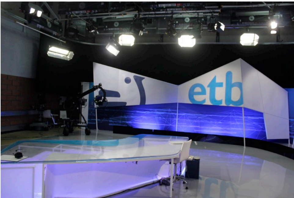
Luminarias de relleno.
