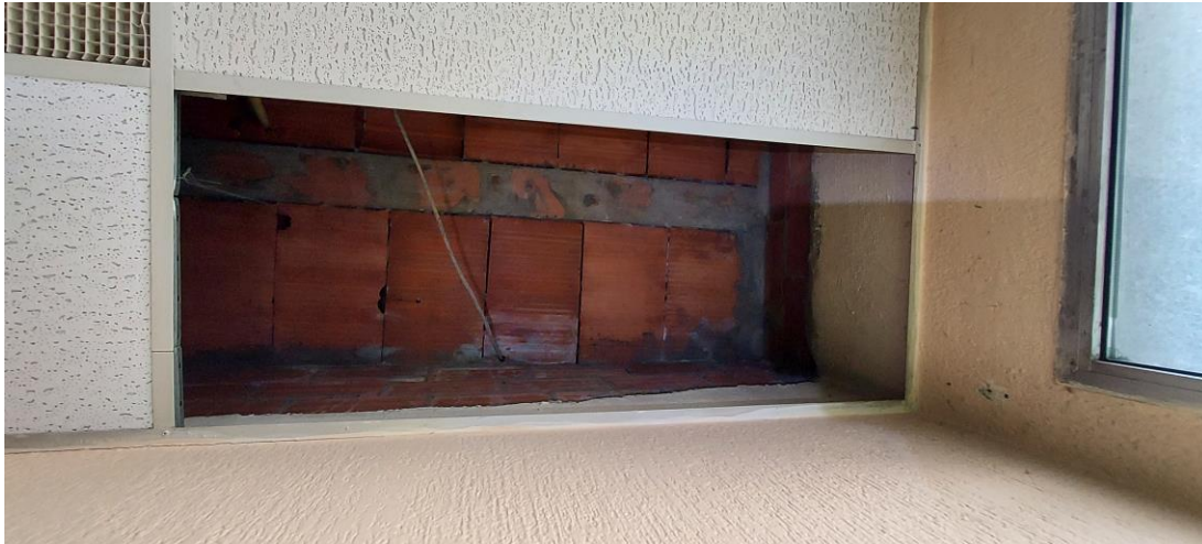
Ilustración 20: Comprobación de la composición de los forjados. Bovedillas cerámicas dispuestas sobre semi-viguetas prefabricadas.
