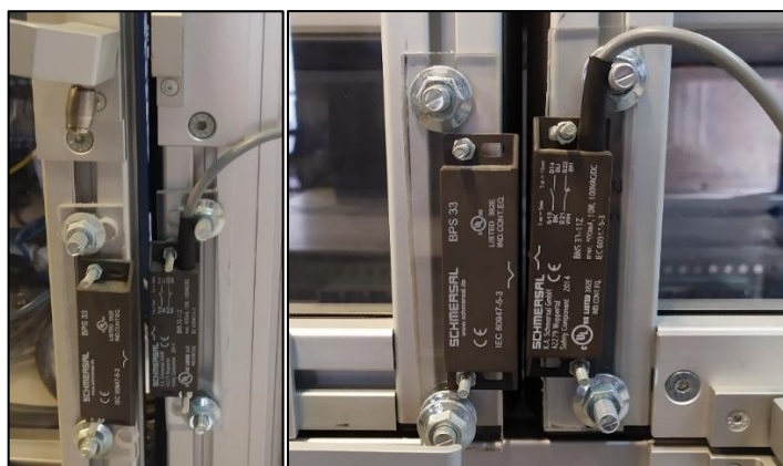
Figura 6.72. Sensores de las puertas del circuito de seguridad.
