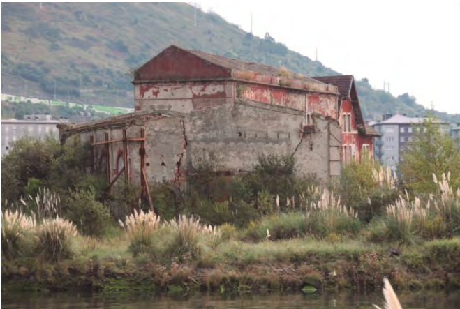
Imagen 18. Fotografía de la parte trasera del pabellón de la Central de Fuerza. En la imagen se aprecia como la edificación está en una situación extrema que requiere una intervención inmediata.
