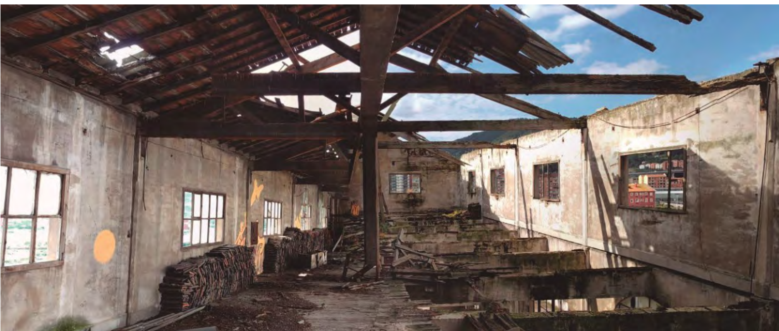
Imagen 1. Fotografía del estado de las cubiertas del Edificio Principal antes de su reparación. Fuente: Informe Desmontaje y sustitución de cubiertas de fibrocemento, canalones y bajantes .
