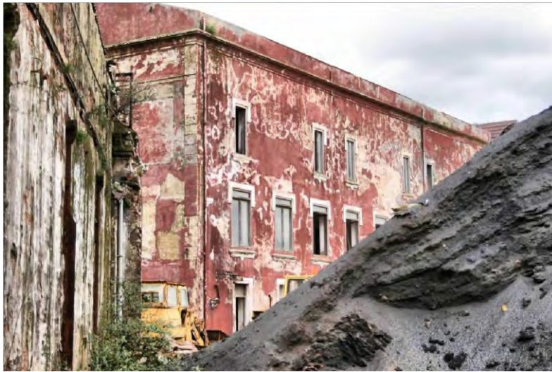
Figura 8. En la imagen izquierda se observa como la base un montículo de gran tamaño de material de construcción apoya en la pared de una de las naves protegidas de Talleres de Zorroza, invadiendo el área protegida (Fuente: AVPIOP).
