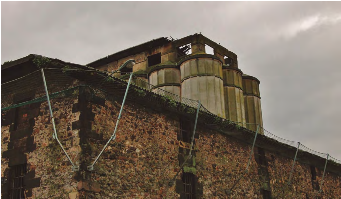
Figura 191. Fotografía de la fachada del Pabellón de la Cordelería del Astillero Real de Zorroza, en primer término, con la estructura de contención contra desprendimientos.
