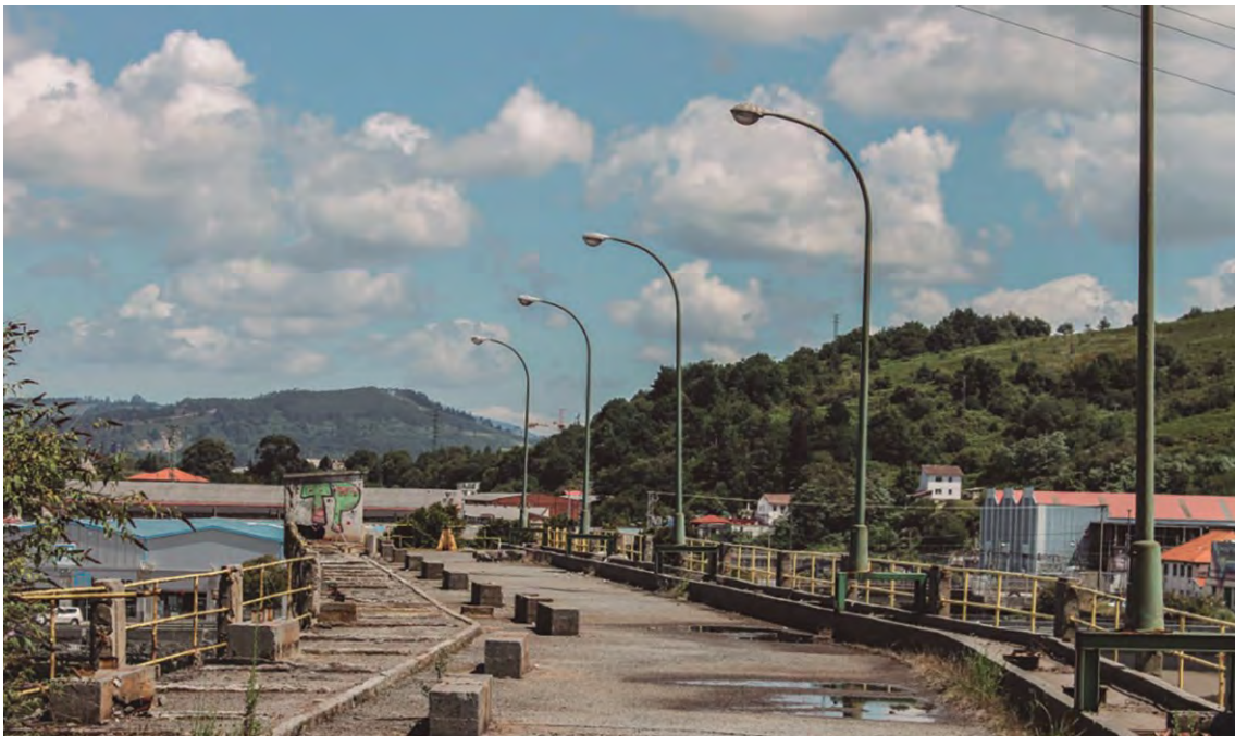
Figura 421. Fotografía de 2018 que muestra la parte superior del cargadero con evidentes daños por su negligente conservación.
