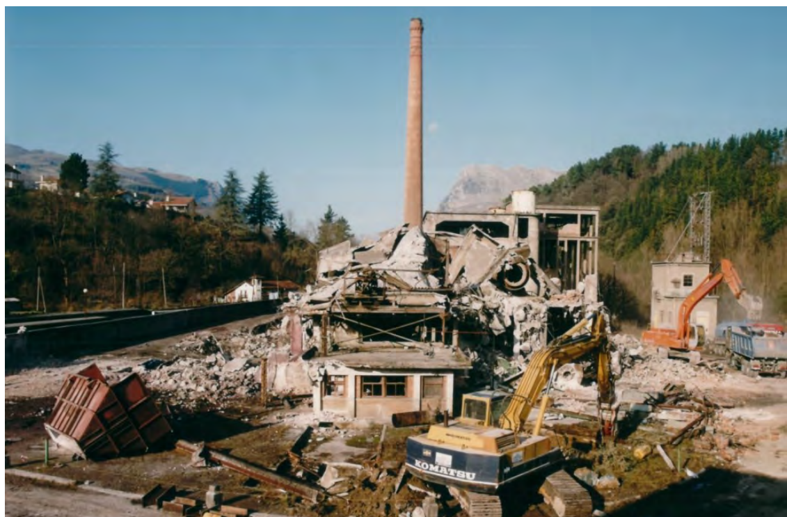
Figura 220. Fotografía de una de la demolición de la Fábrica Dolomitas en Karrantza ejecutada por el PDRRII.
