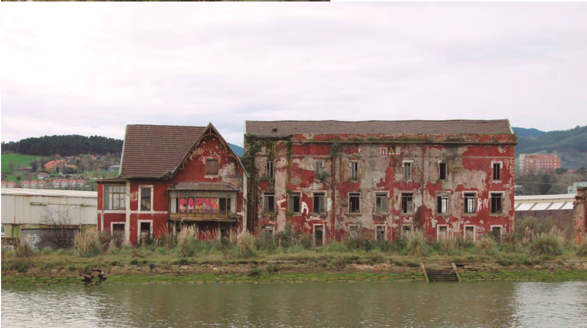
Imagen 20. Fotografía de las edificaciones adosadas de las oficinas y la vivienda del Conjunto Monumental. En la imagen se aprecia la degradación de ambos inmuebles.
