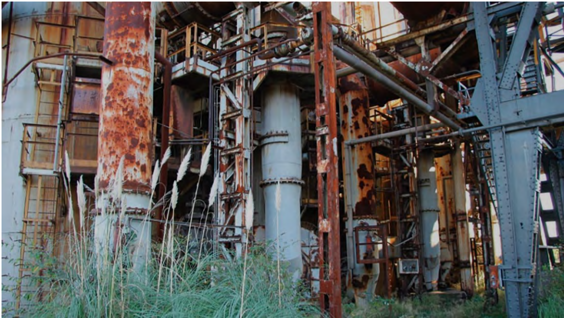
Figura 179. Fotografía de detalle de la oxidación y degradación que afecta a la estructura del Horno Alto N°1 por la falta de mantenimiento.
