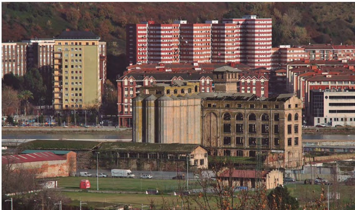
Figura 196. Fotografía de la parte trasera del complejo de GRANDES MOLINOS VASCOS en la que se aprecia la grave degradación de las cubiertas de la edificación patrimonial. La cubierta de los silos ha desaparecido totalmente.
