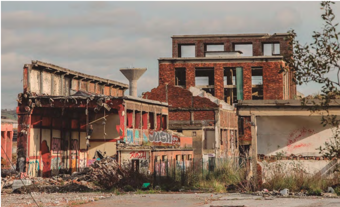
Figura 688. Fotografía de las últimas instalaciones de BWE antes de su derribo definitivo.
