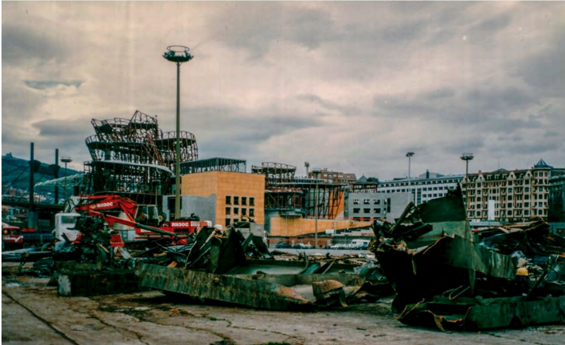
Figura 787. Copia de la fotografía original de la demolición de los Tinglados de Abandoibarra encontrada en el archivo del Departamento de Ordenación del Territorio del Gobierno Vasco.
