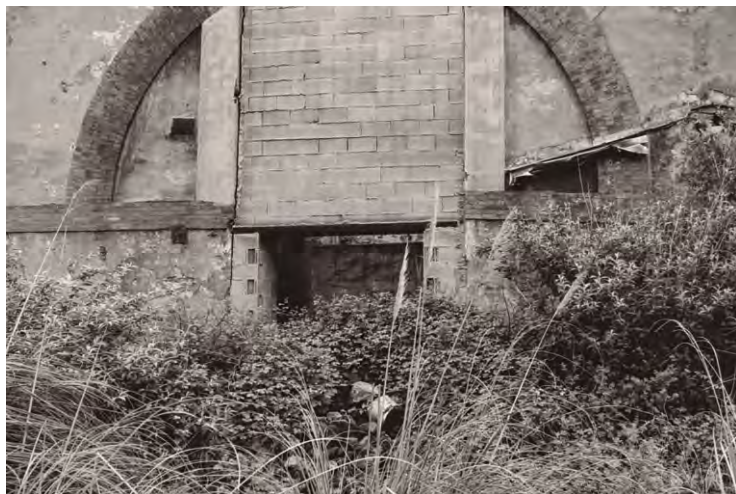
Figuras 165, 166 y 167. Fotografías del interior del Pabellón de la Central de Fuerza. En esta imagen se muestran los efectos de décadas de abandono, de mal uso y de nula inversión en su mantenimiento.
