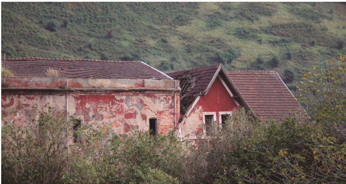
Imagen 22. Vista frontal de las cubiertas de las edificaciones de oficinas y vivienda. En la fotografía se puede observar la extrema degradación de las cubiertas.
