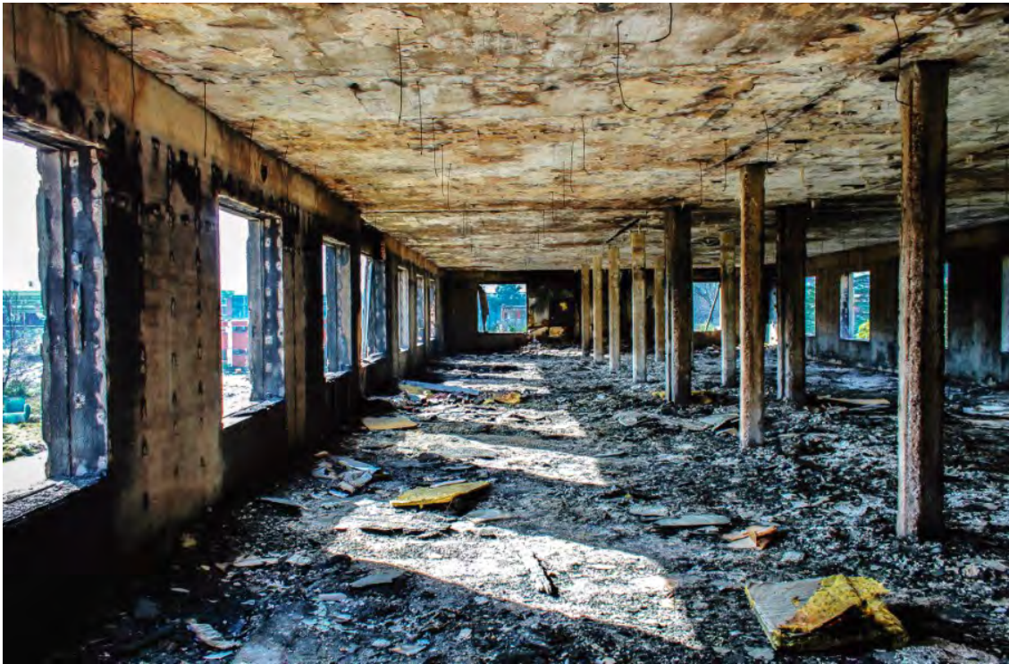
Figura 677. Fotografía de una de las salas calcinadas del edificio de las Oficinas Generales de BWE.
