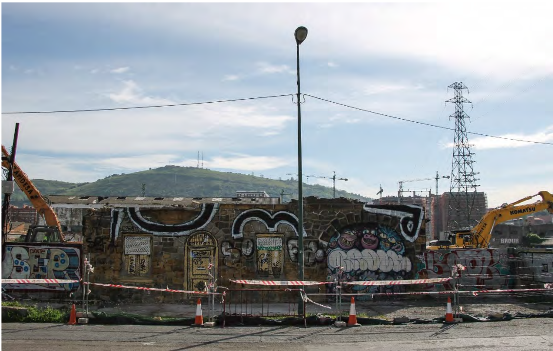
Figuras 382 y 383. Comparativa de imágenes del estado de la Casa del Guarda de CROMODURO . En la imagen izquierda (2017) se muestra esta edificación fabril antes de su demolición. En la imagen derecha (2019) se muestran las labores de derribo del mencionado edificio patrimonial.
