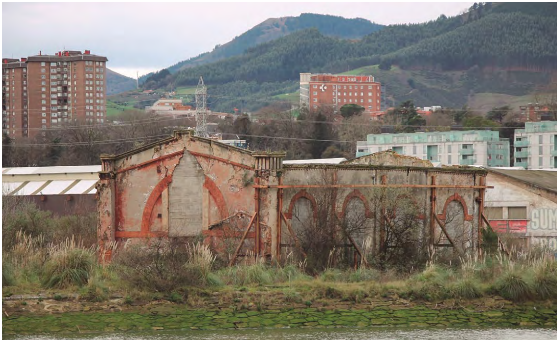
Figura 164. Fotografía del exterior del pabellón de la Central de Fuerza. Tal y como se puede comprobar a simple vista, la degradación de la edificación es extrema, ya que ha perdido totalmente sus cubiertas y sus agrietadas paredes apenas se mantienen en pie.
