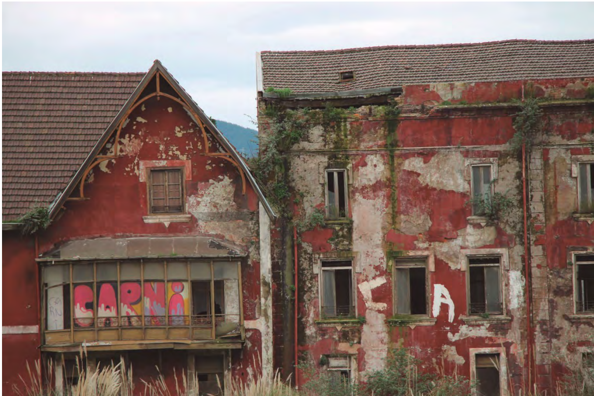
Imagen 21. Fotografía de detalle de la inserción de ambas instalaciones, donde se puede apreciar la colonización vegetal de las fachadas y la pérdida de material y la deficiente conservación de las cubiertas de éstas.
