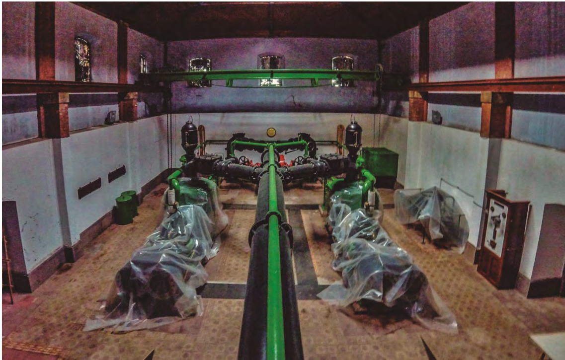
Figura 588. Fotografía de la sala de máquinas de la BOMBADORA DE AGUAS DE ELORRIETA. En la imagen se puede observar cómo se protege la maquinaria con plásticos para evitar su oxidación.
