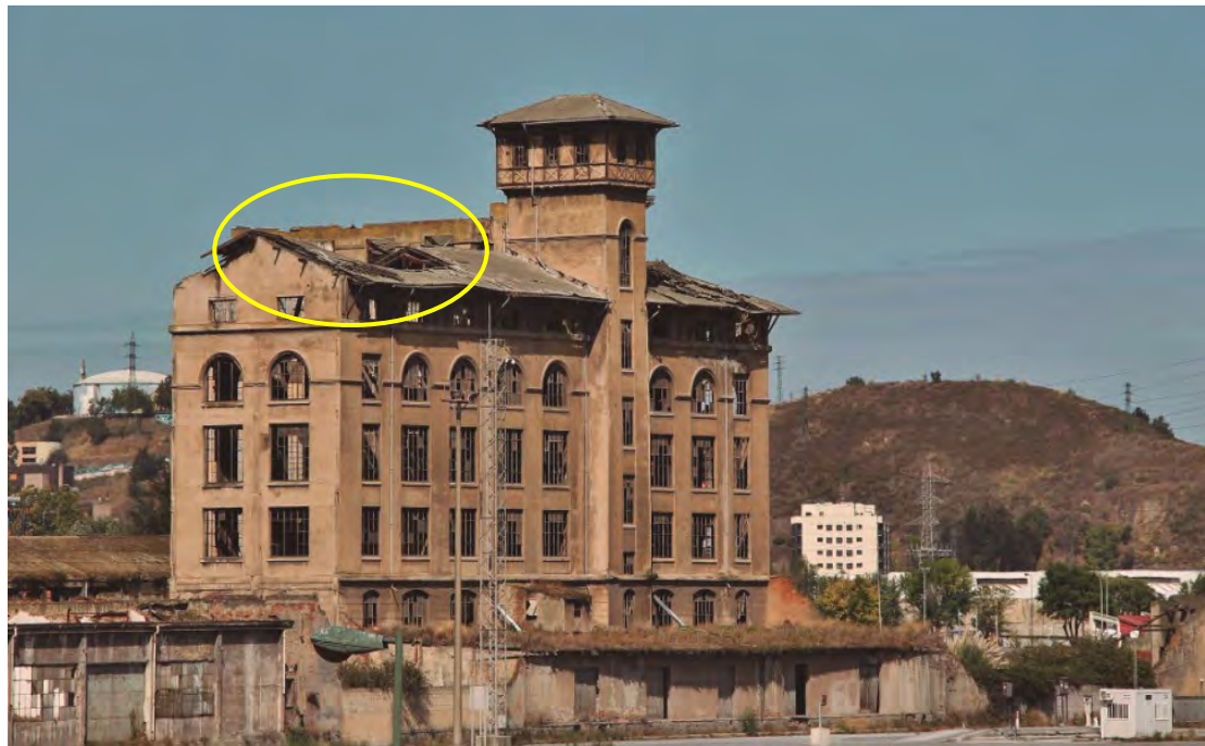
Imágenes 3 y 4. Comparativa fotográfica del avance en la degradación de las cubiertas del Edificio Principal en los últimos 6 años. La imagen superior, de 2018, muestra el principio de degradación en el frontal de la cubierta principal en la parte de la fábrica de pisos. En la imagen inferior, de 2021, se aprecia el derrumbe de parte de la estructura de la cubierta frontal del Edificio Principal. El estado de abandono y degradación de este monumento es notorio y visible. Fuente: Alberto Salcedo.
