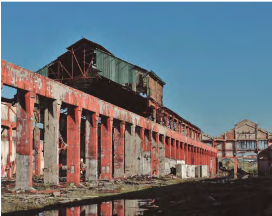
Figura 679. Fotografía de 2017 del acceso principal y el edificio de las Oficinas Centrales vistos desde los Talleres Generales. Se aprecia la acumulación de escombros y basura y la imagen de degradación generalizada del complejo.
