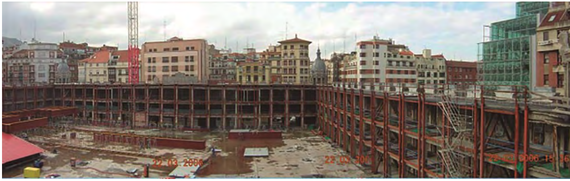
Figura 494. Fotografía que muestra la estructura de pilares de acero que se construyeron para reforzar la cruja original.
