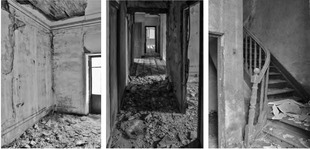
Figura 9. Imagen superior que muestra el exterior del edificio de oficinas y vivienda del Conjunto Monumental de los Talleres de Zorroza. Figuras 10, 11 y 12 muestran el grave deterioro general, consecuencia del abandono de este edificio protegido, además de probar la inexistente inversión en mantenimiento realizada por la propiedad. (Fuente: Alberto Salcedo, 2020).
