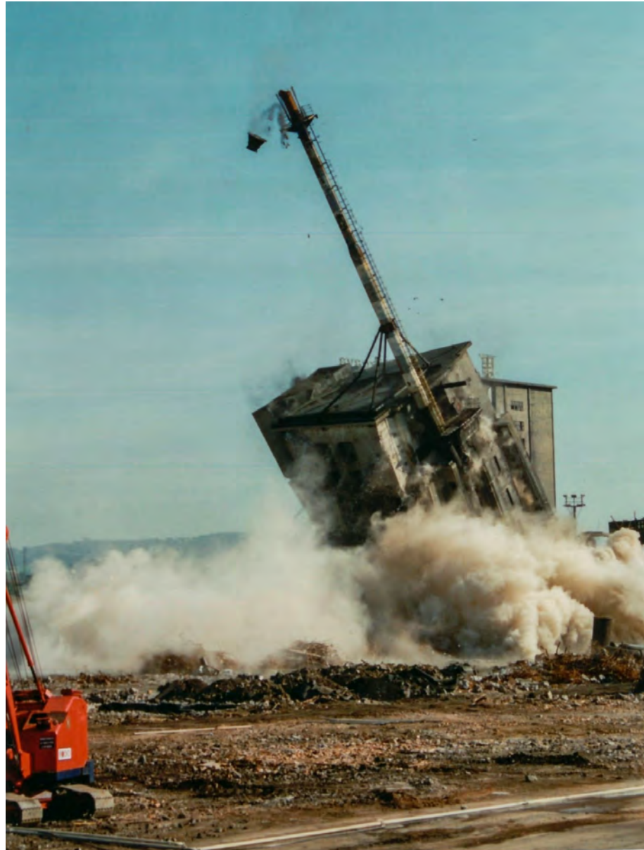
Figura 792. Copia de la fotografía original de la demolición de una de las torres de refrigeración del complejo de AHV en Sestao encontrada en el archivo del Departamento de Ordenación del Territorio del Gobierno Vasco.
