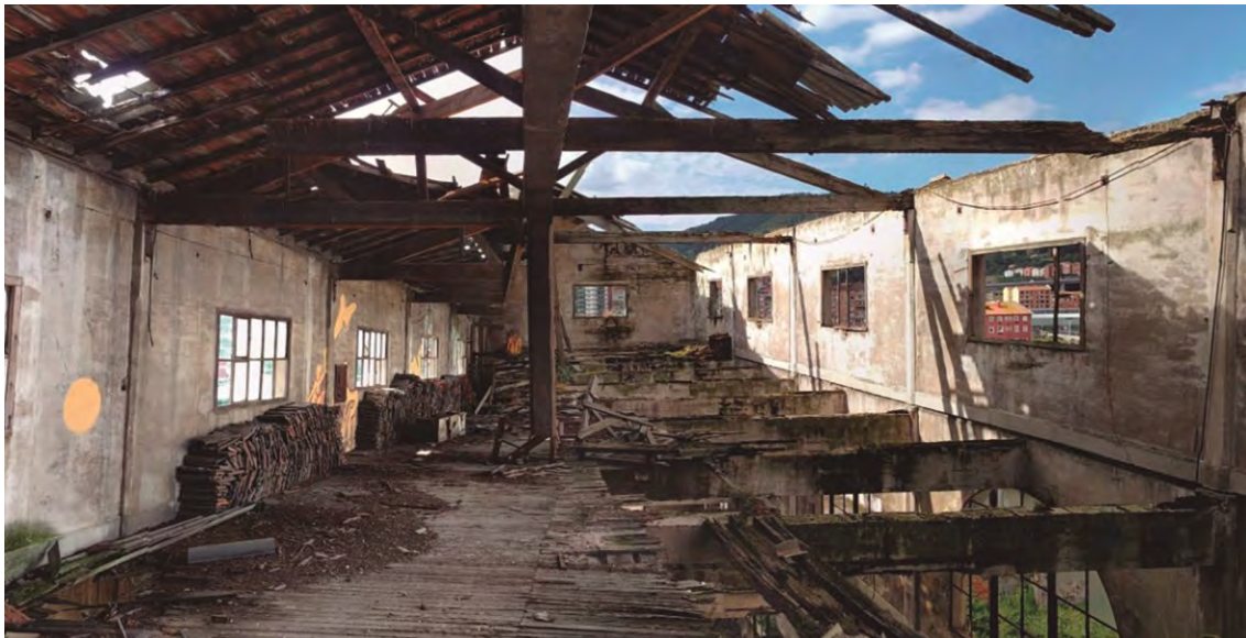
Figuras 192 y 193. Comparativa fotográfica del estado de las cubiertas del Edificio Principal antes y después de la reparación de sus cubiertas. En la imagen izquierda se muestran las cubiertas antes de su reparación. En la imagen derecha se muestra el estado actual de las cubiertas desde el interior del Edificio Principal.
