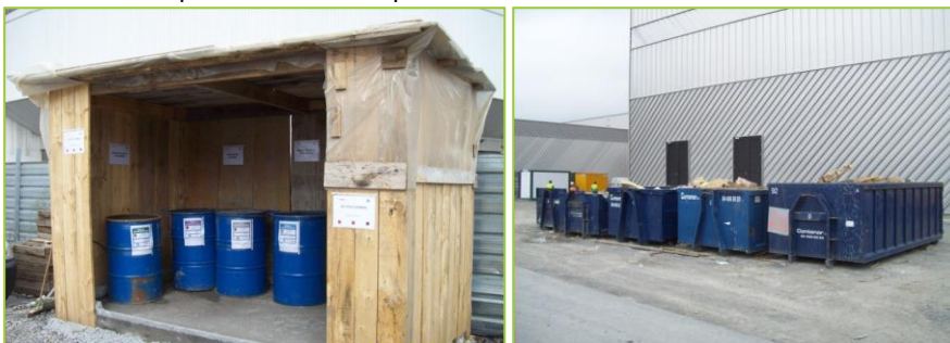
Ejemplos de punto limpio y almacenamiento de residuos no peligrosos por medio de contenedores
