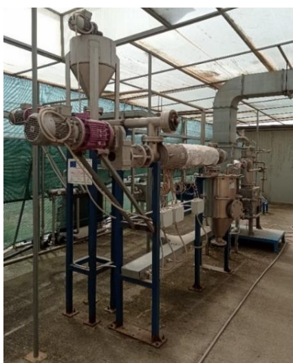
Figura 4.2. Imagen general de la planta piloto de pirolisis.
