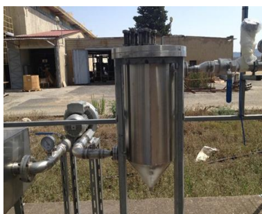
Figura 4.10. Filtro de arena.
