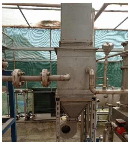
Figura 4.7. Intercambiador de calor.
