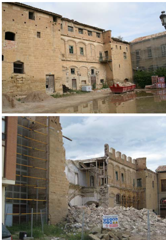
Figura 1: Vista de la fachada del Palacio antes y después del derrumbe de junio de 2008
